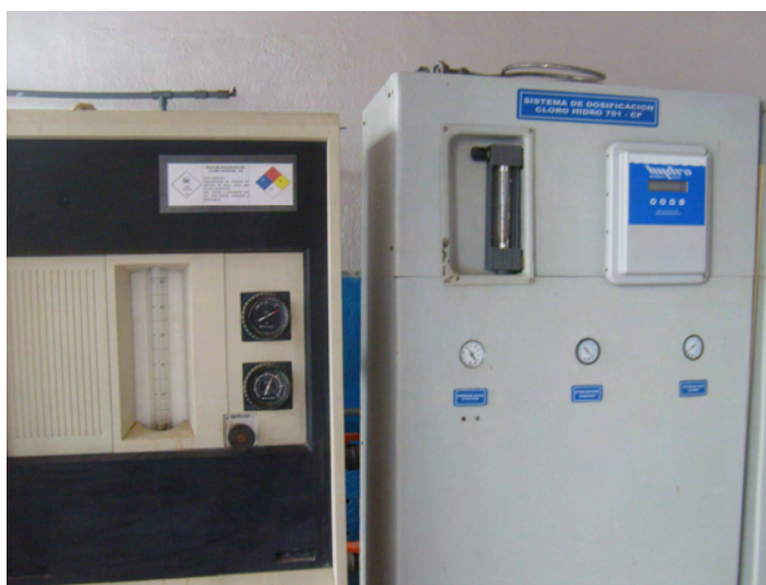
Grafica 18. Sistema de dosificación de cloro gas (planta EMPOPASTO)
