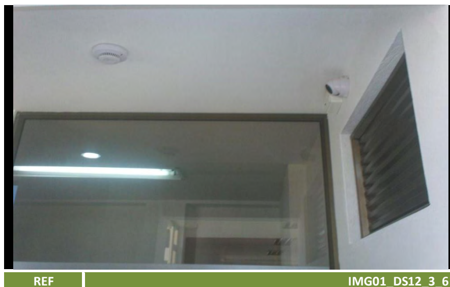
Figura 14. Sensores de humo y cámara (IMG01_DS12_3_6)
