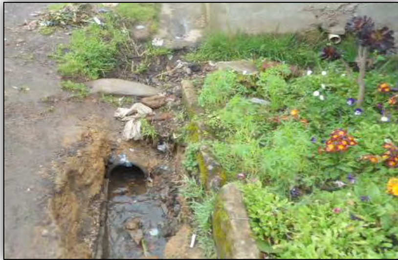
Fotografía 4.1. Cuneta artesanal ubicada en la vereda Fátima.
