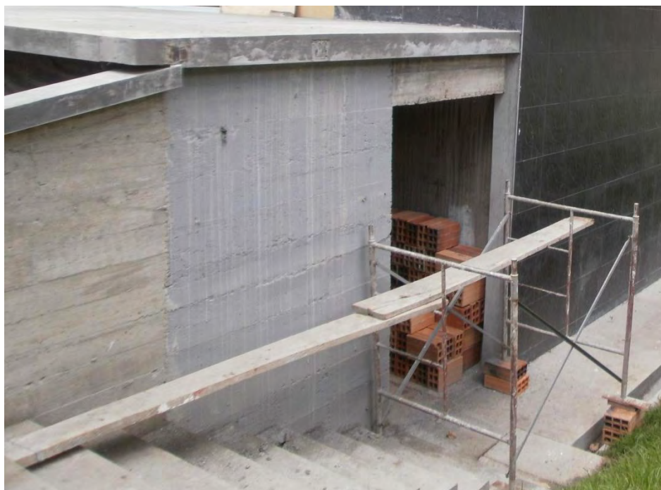
Figura 13. Aplicación de pañete no presupuestado.
