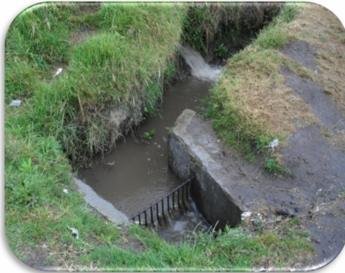
Fotografía 9. Alcantarilla, corregimiento de Buesaquillo.
