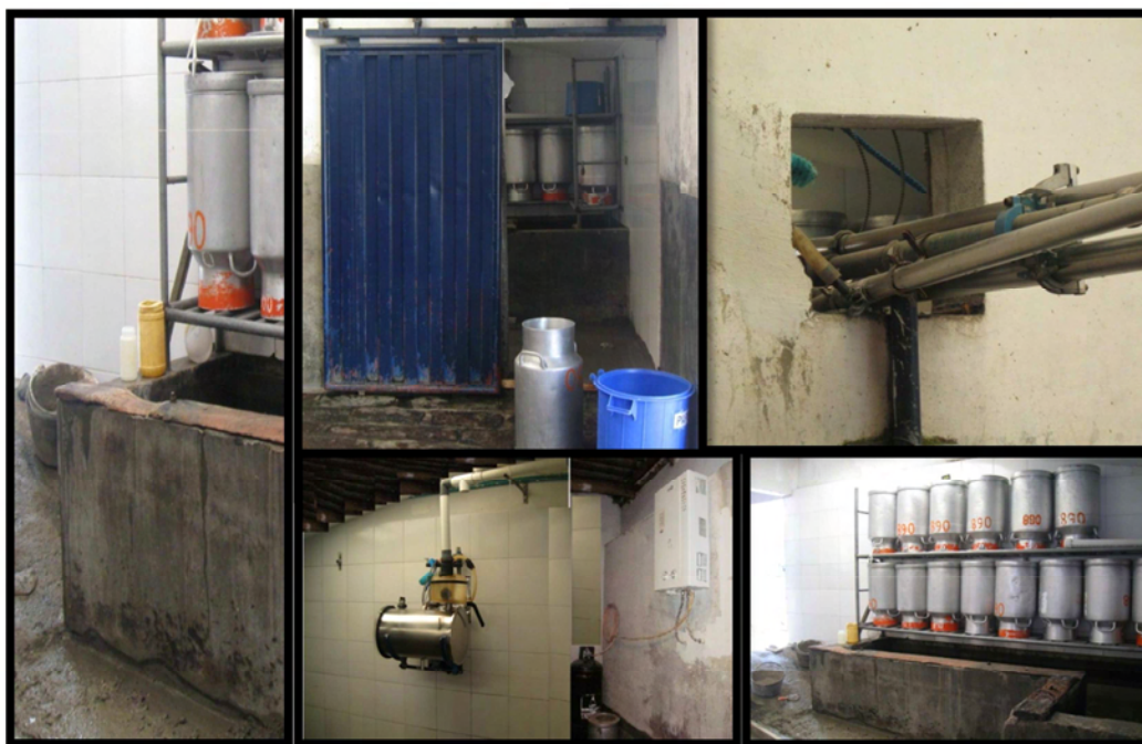
Figura 21. Estado sala de leches. Cascajal
