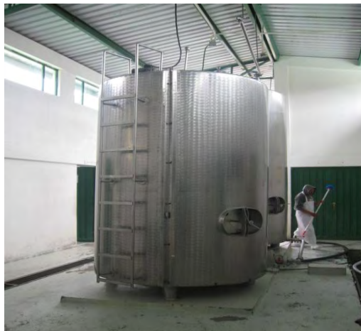
Figura 29. Tanque de enfriamiento interno
