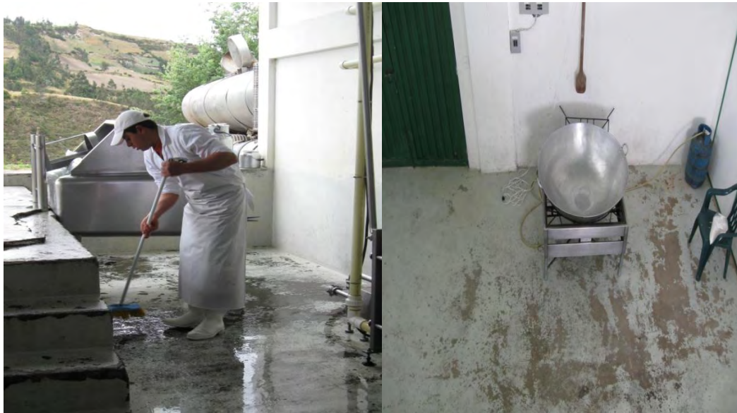
Figura 45. Pisos desgastados de la planta principal.
