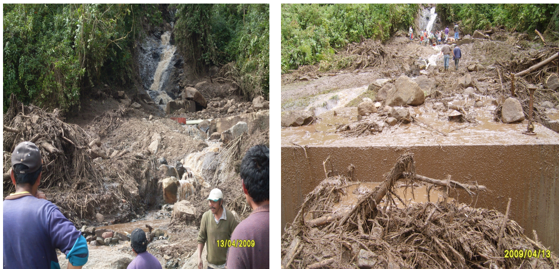
Figura 9. Daño en bocatoma Cantera uno por inundación de la quebrada Pilispí. Año 2009
