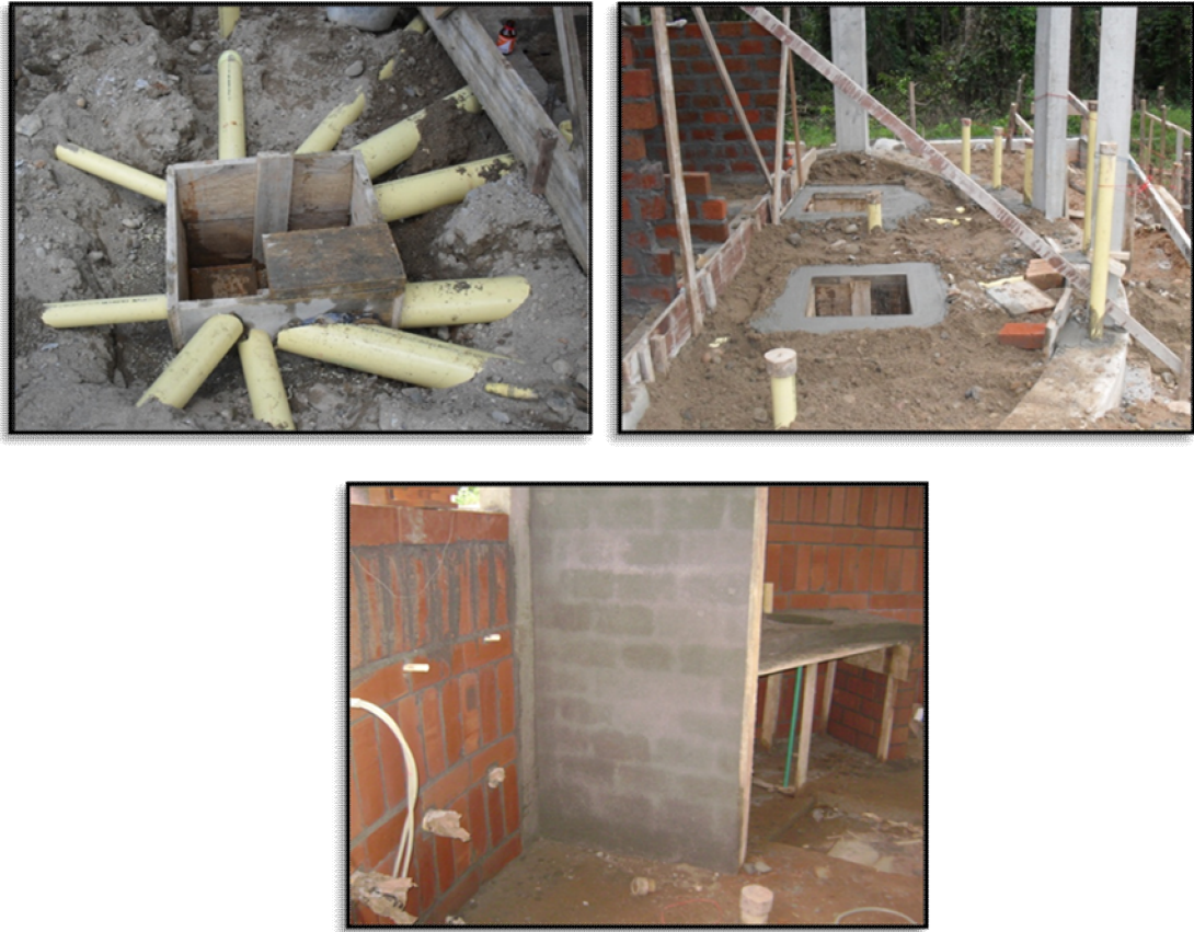
Ilustración 28. Cajas de inspección y puntos sanitarios para lavamanos y orinales.
