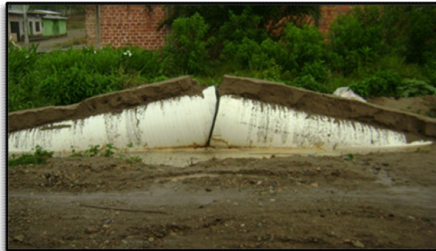
Ilustración 53. Levantamiento tramo de tubería por fuerte invierno.
