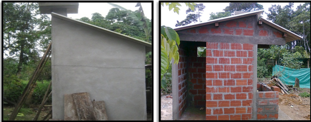
Ilustración 1. Unidades sanitarias en las veredas la pedregosa y la esmeralda
