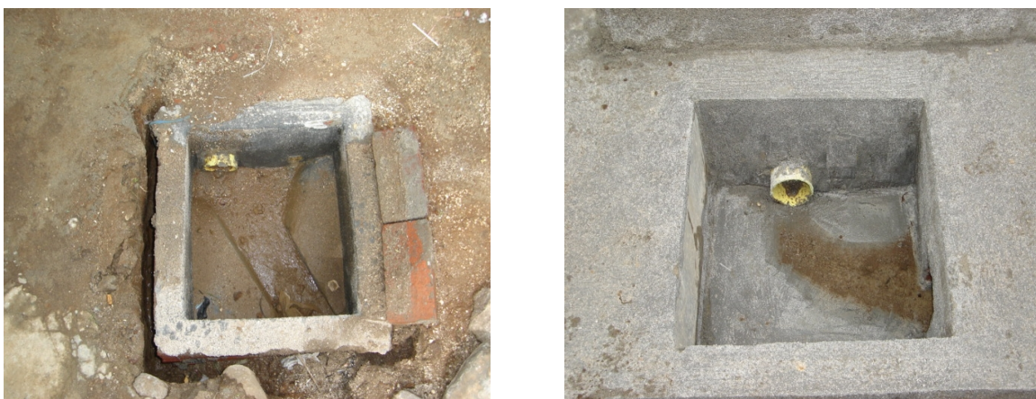
Figura 124. Cajillas que reciben aguas negras
