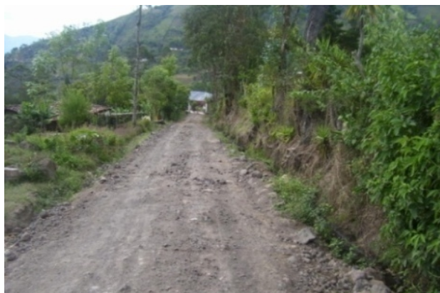
Figura 76. PR 1+400, estado actual de vía
