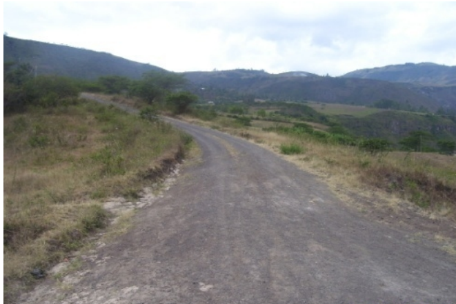
Figura 75. PR 5+100, estado actual de vía
