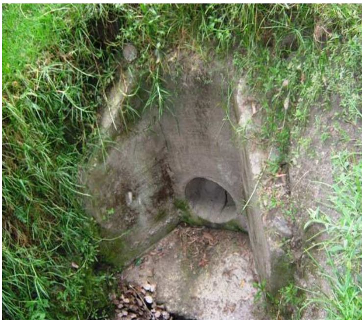
K 1+0850; N1 36.931 W76 56.905. Alcantarilla de 36", Caja de salida, Falta de rocería.
