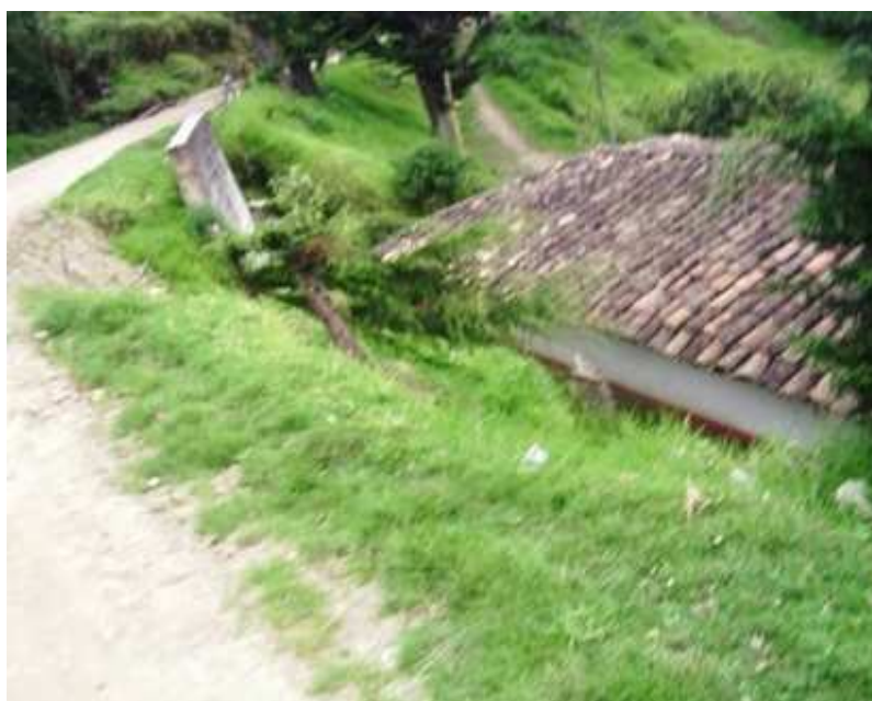
K 3+0180; Se requiere construcción de un muro de contención que complemente existente, riesgo inminente vivienda bajo el talud .
