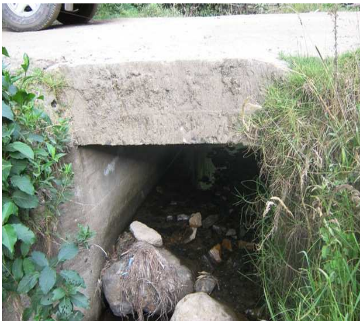
K 3+0900; N1 37.031 W76 56.534. Pontón en concreto, Buen estado. Falta de mantenimiento.
