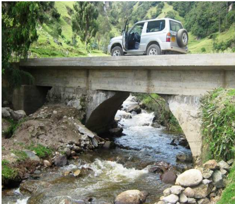
K 2+0550, N1 33.676 W76 55.365. Pontón en concreto, necesita recalzar los estribos por socavación, ya que dentro del área hidráulica existen estribos construidos anteriormente.
