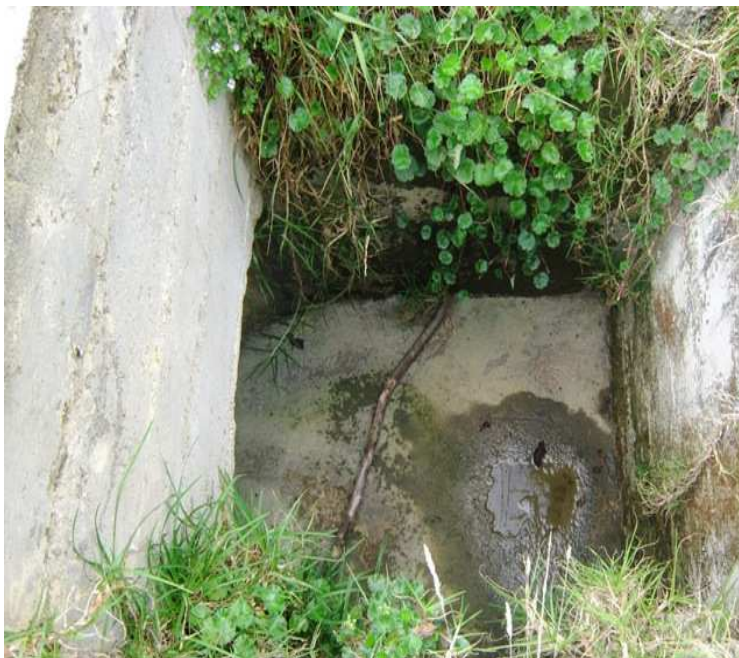
K 7+0000; Alcantarilla de 36", caja de entrada alcantarilla en buen estado, falta rocería.
