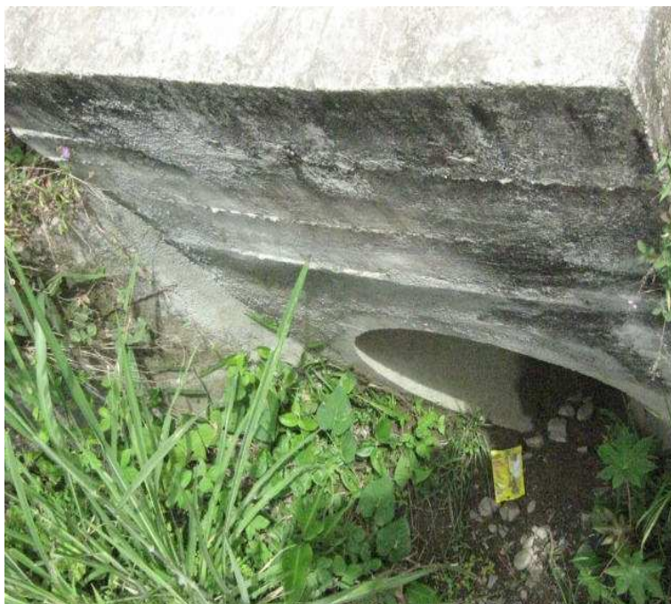
K 3+0450, N1 39.189 W77 04.623. Alcantarilla de 36" caja de salida en buen estado nueva, Falta de mantenimiento.
