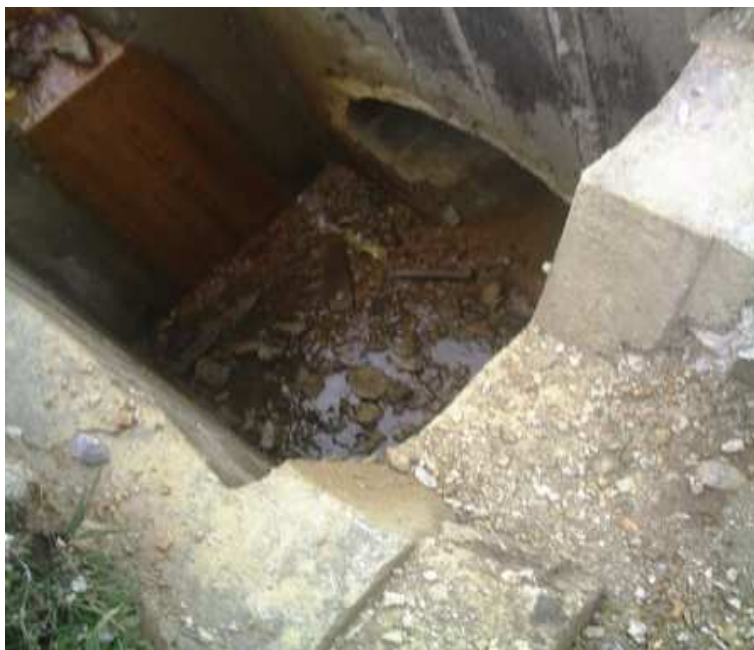
K 2+0150; N1 36.332 W77 00.706. Caja de entrada de alcantarilla, falta de mantenimiento.
