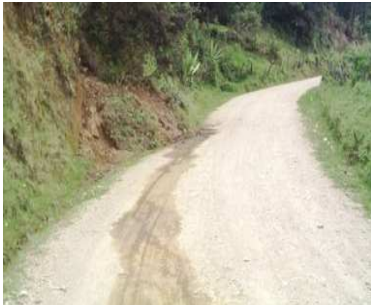
K 2+0150; Presencia de agua en el afirmado.
