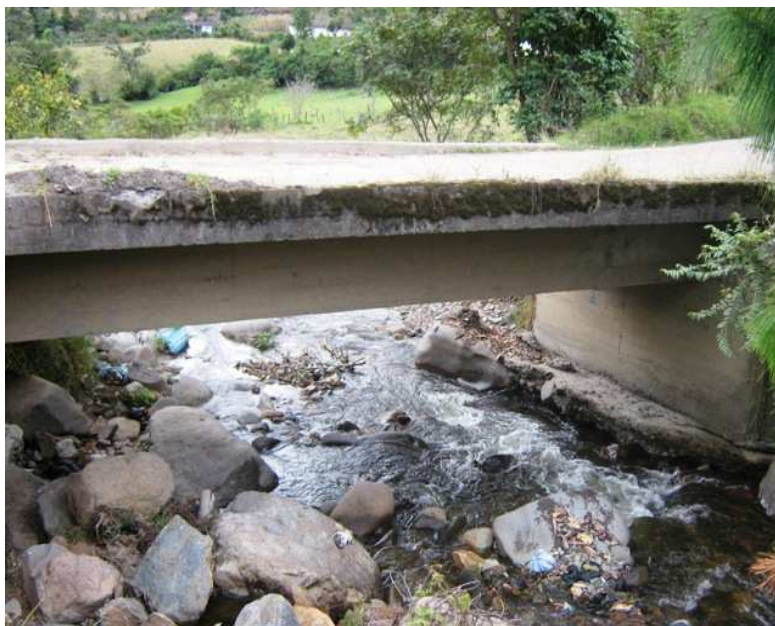
K 5+0000; N1 37.455 W76 56.504. Pontón en concreto. Falta de mantenimiento.
