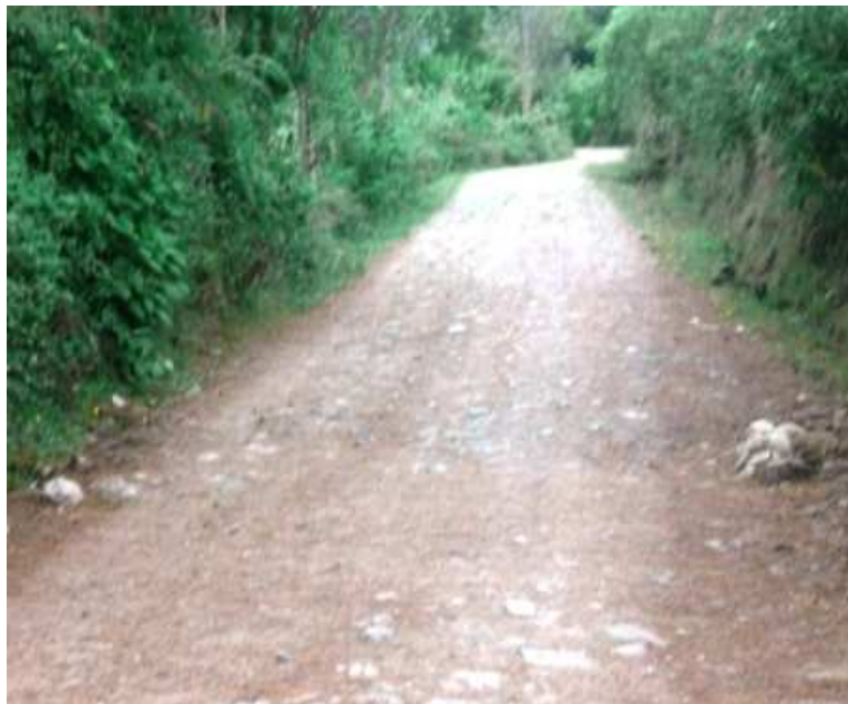
K 10+0900; Necesidad de limpieza en la banca.
