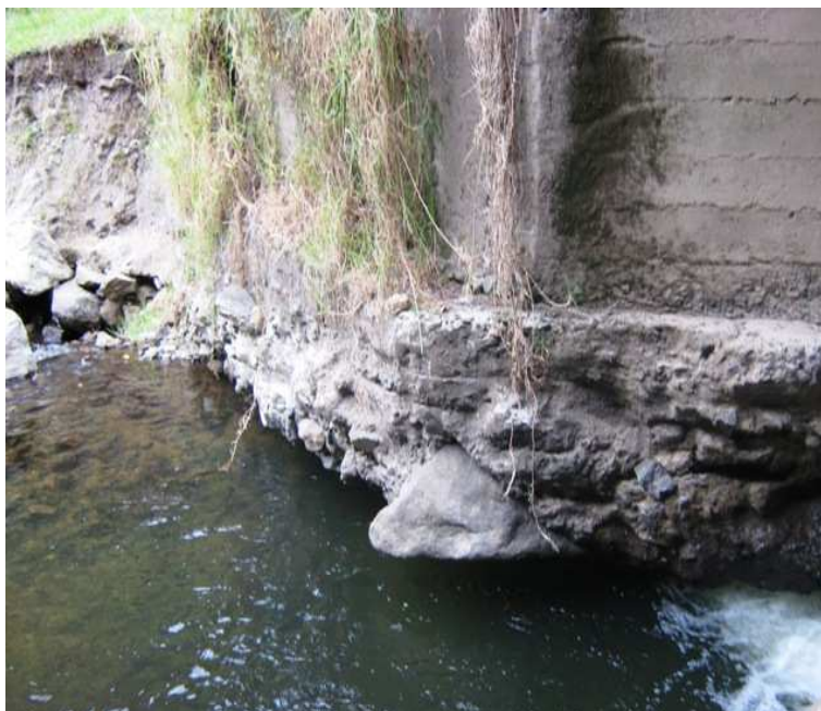
K 5+0000; N1 37.455 W76 56.504. Pontón en concreto, estribos presentan socavación.
