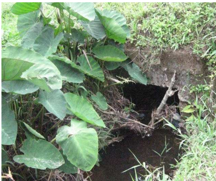
K 6+0100, N1 38.405 W77 05.361. Box Couver falta de mantenimiento, rocería pero funcionan bien.
