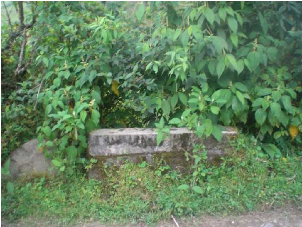
Fotografía N° 89 Falta de rocería y mantenimiento.
