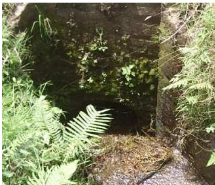
K 2+0150; N1 36.332 W77 00.706. Caja de salida de alcantarilla, falta de mantenimiento.
