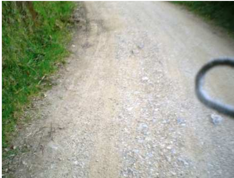
K 3+0100; Falta material fino.
