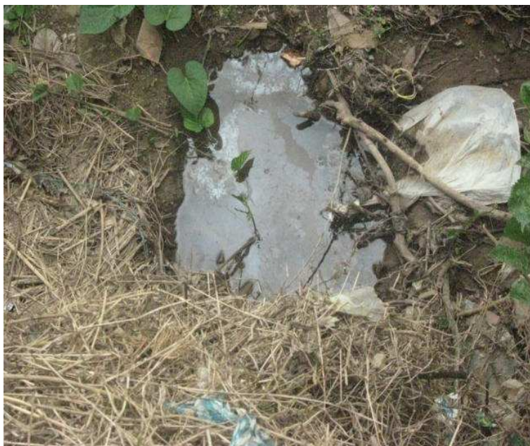
K 4+0700, N1 38.857 W77 04.999. Alcantarilla de 24",se requiere hacer mantenimiento y destaparla porque esta colmatada.
