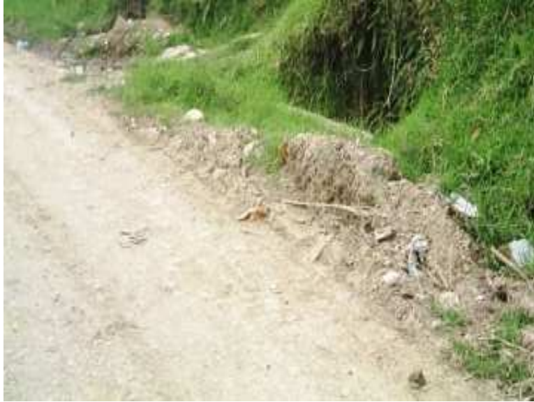
K 0+0100; Falta material fino.
