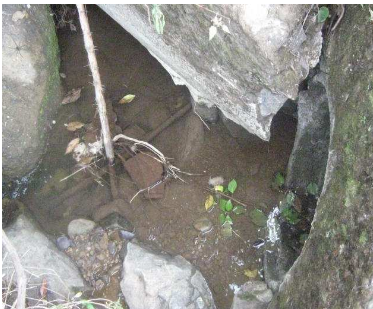
K 4+0300, N1 38.967 W77 04.884. Alcantarilla de 24", aletas de caja de salida destruido requiere reconstruirlo.
