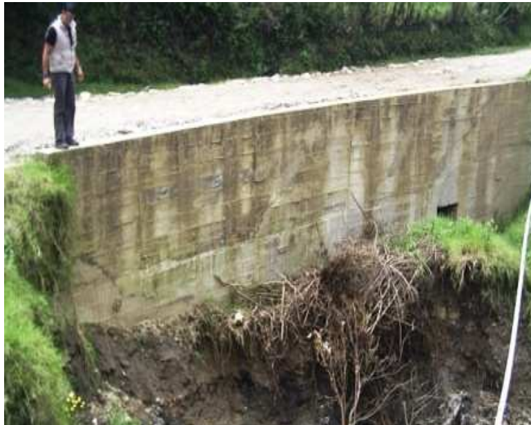
K 1+0810; N1 36.360 W77 00.856 Muro en concreto reforzado, bajo el cual existe una alcantarilla de 24".
