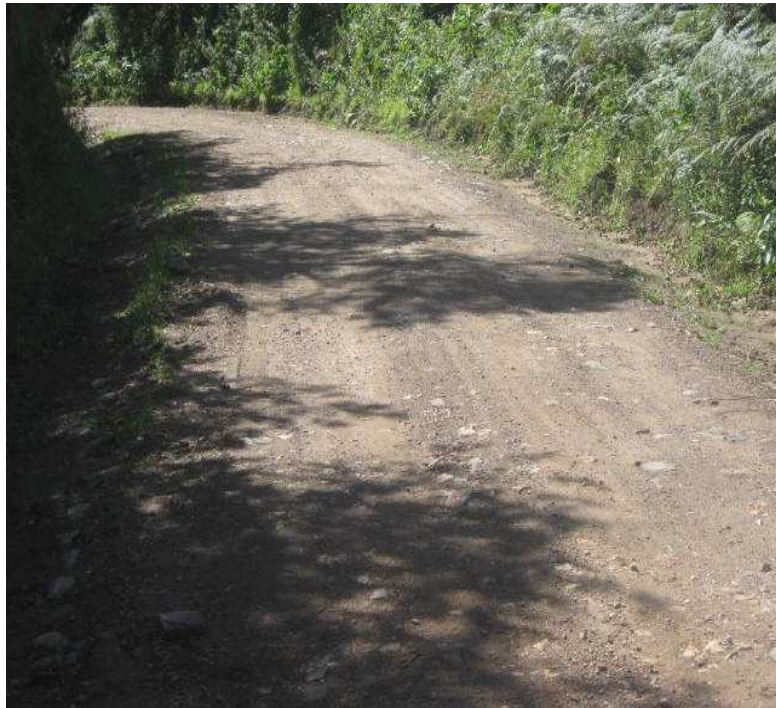
K 12+0100, Falta de material fino.
