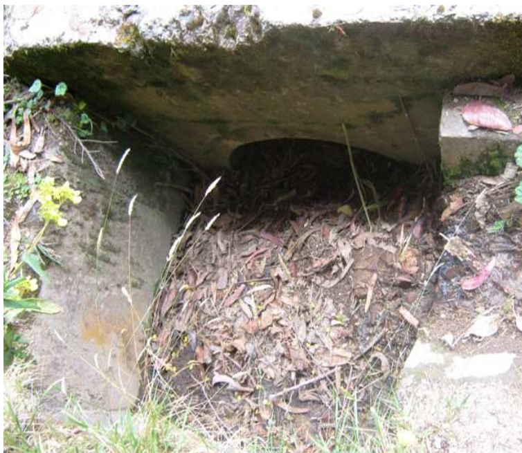
K 6+0000; N1 32.524 W76 59.051. Alcantarilla colmatada, se requiere destapar para que puede cumplir su función.
