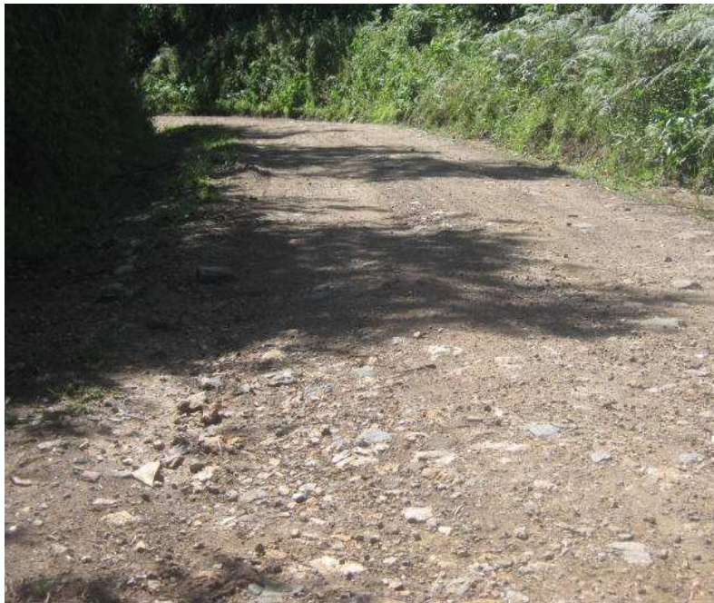
K 2+0000, Falta de material fino.
