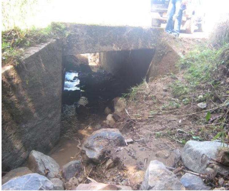
K 11+0250; N1 37.243 W77 03.391. Buen estado, Pontón en concreto falta de mantenimiento.
