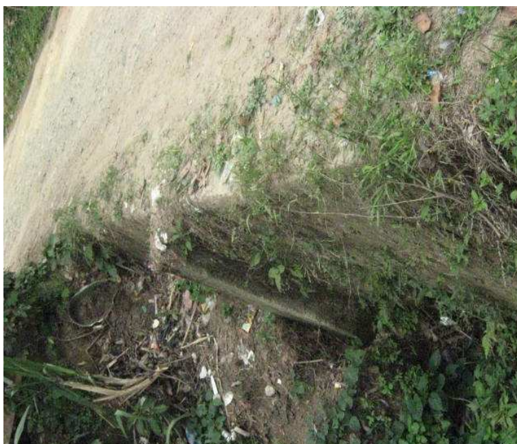
K1+0200; N1 39.569 W77 03.865 Muro en concreto reforzado. Falta de rocería
