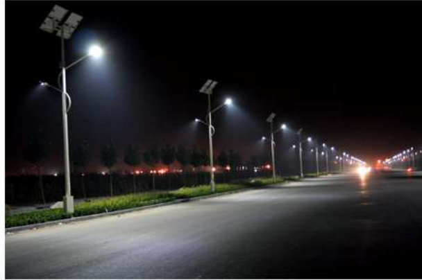
Iluminación con LEDs, energía suministrada por energía solar
