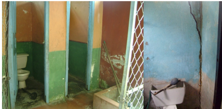
Figura 47. Estado actual batería sanitaria - E.R.M San Antonio de Acuyuyo
