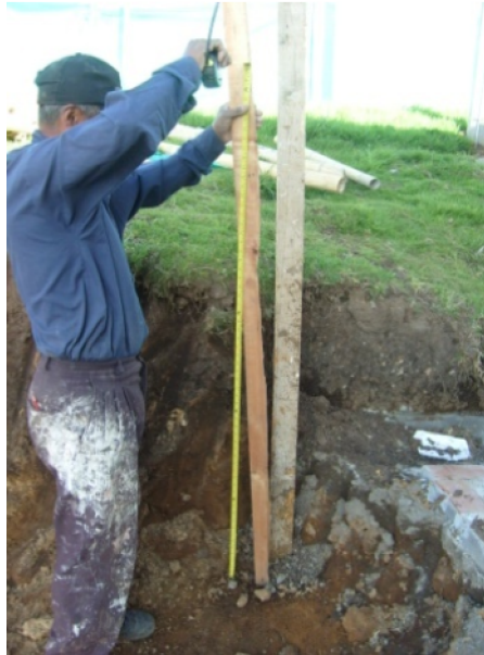
Figura 105. Verificación de niveles
