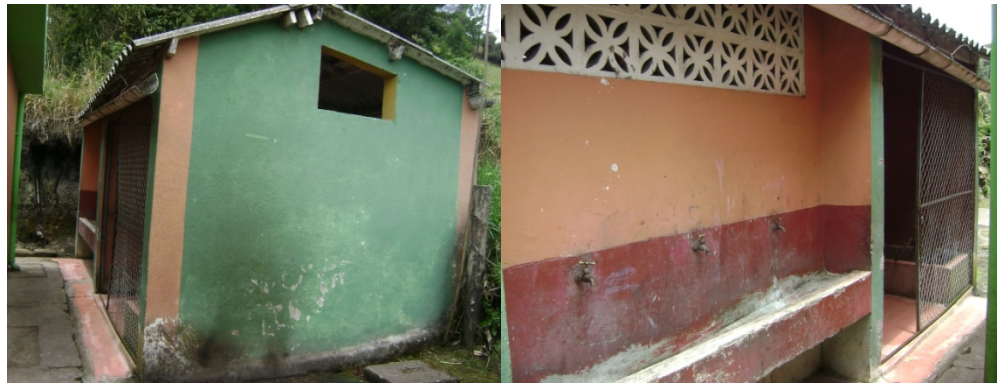
Figura 46. Batería sanitaria - E.R.M San Antonio de Acuyuyo
