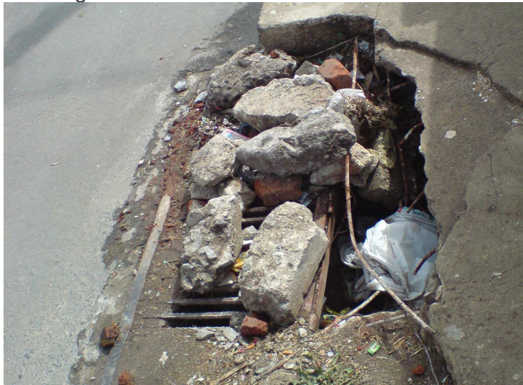
Figura 48. Estado actual de los sumideros.
