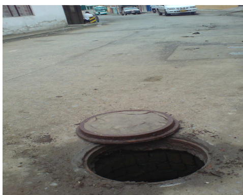
Figura 39. Cámara de empalme
