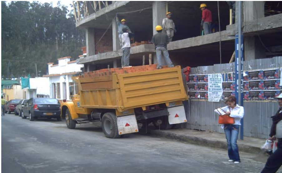
INVASIÓN AL ESPACIO PÚBLICO – ANDENES (Carrera 29 entre calles 20 y 21)
