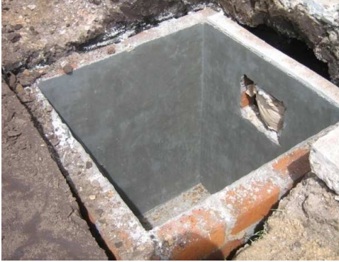
Imagen 10. Cajas de inspección en mampostería.
