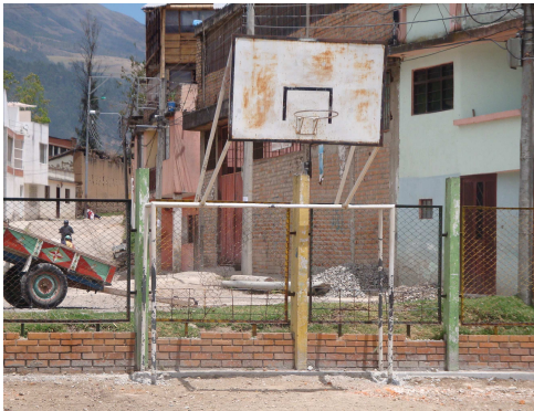
Imagen 135. Canchas en mal estado
