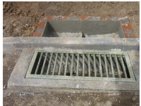
Imagen 9. Rejilla de sumidero.
