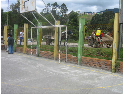
Imagen 133. Mallas en mal estado.
