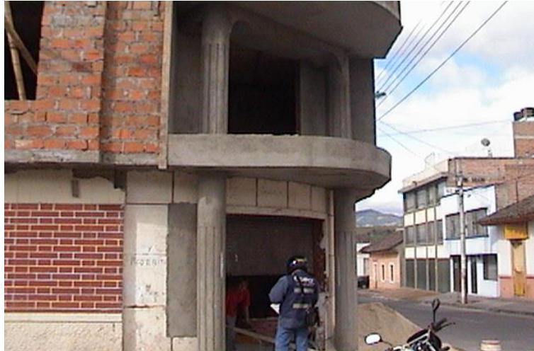
Figura 9. Construcción sin responsable de la obra
