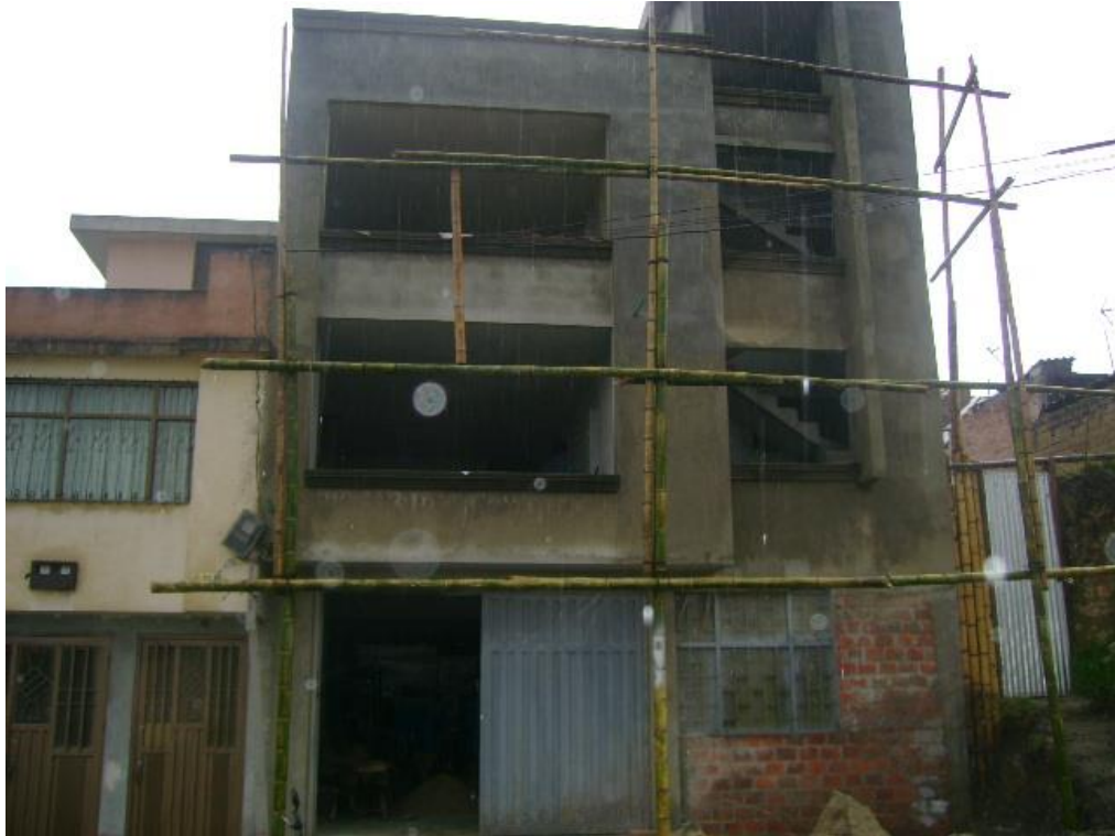
Figura 8. Construcción no ceñida a planos aprobados
