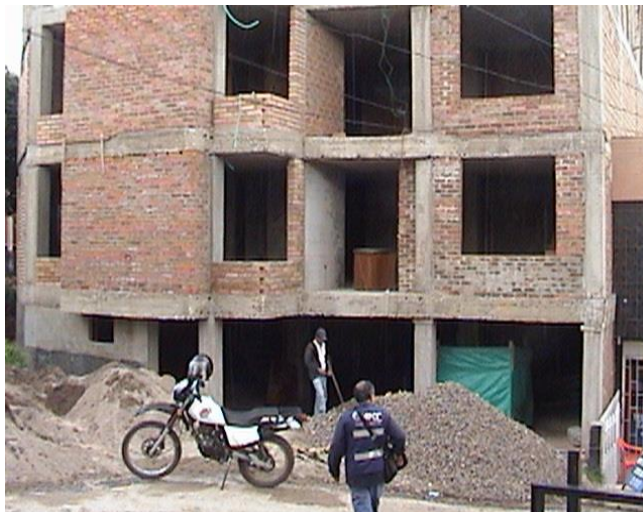
Figura 10. Construcción fuera de paramento
