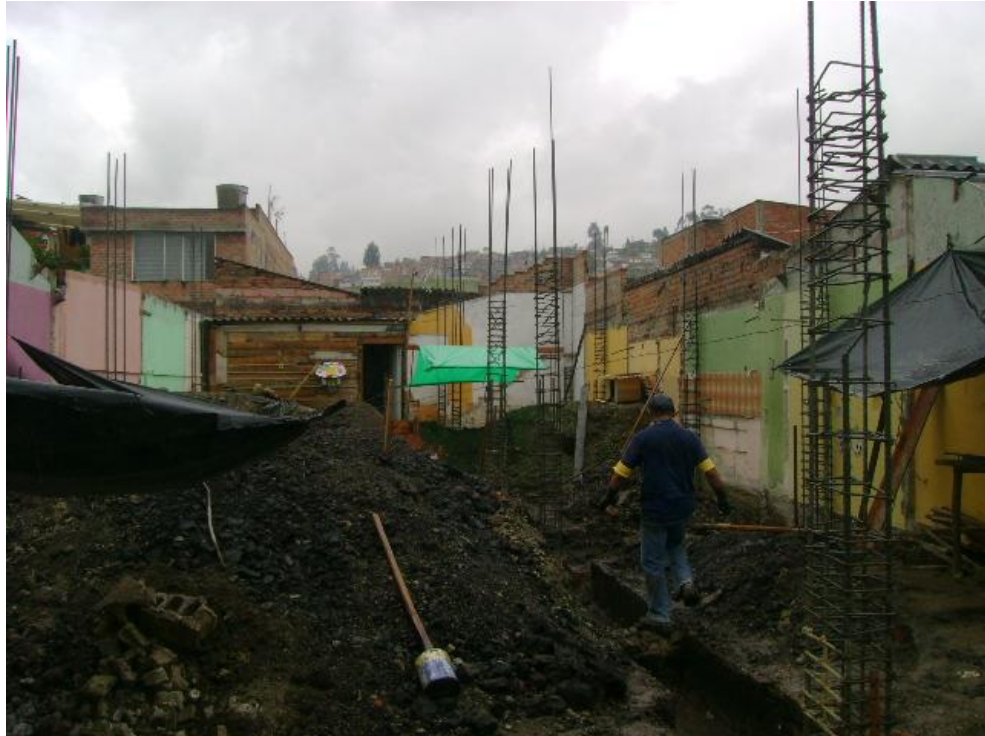
Figura 11. Demolición sin licencia
