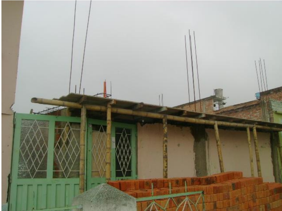
Figura 7. Construcción sin planos aprobados
