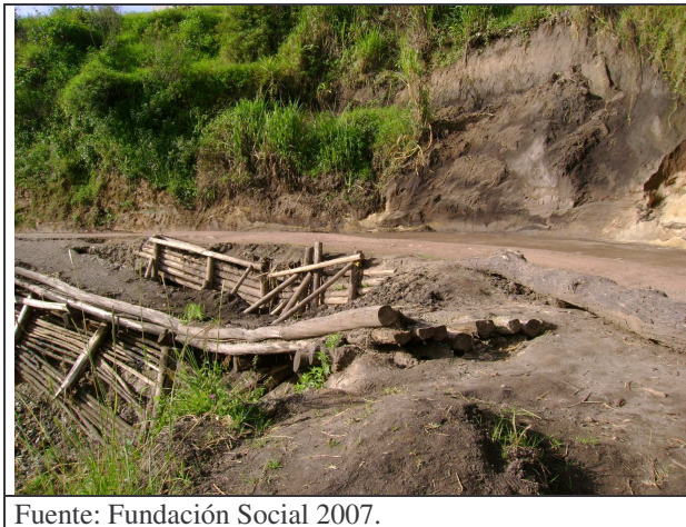
Figura 11. Infraestructura En Mal Estado
