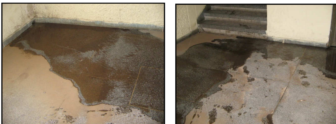
Figura 81. Fuga de aguas negras del Bloque 3.
