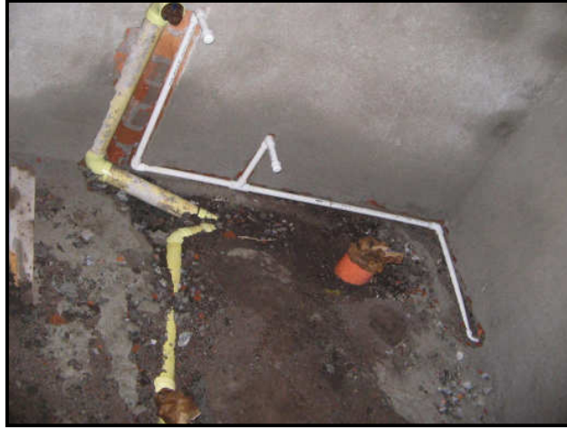
Figura 29. Instalación Hidrosanitaria de los baños - Kiosco de Internet No. 2
