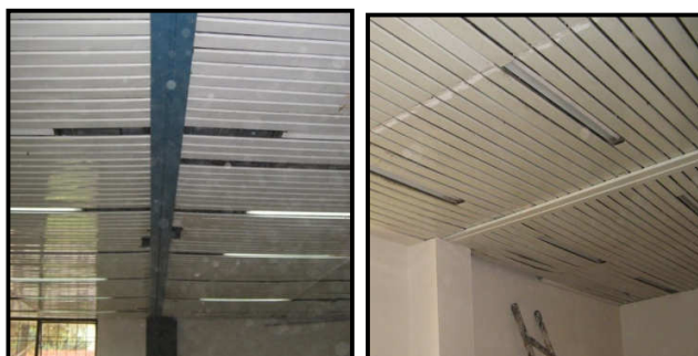
Figura 60. Pintura de cielo raso del laboratorio 2 del Departamento de Física.
