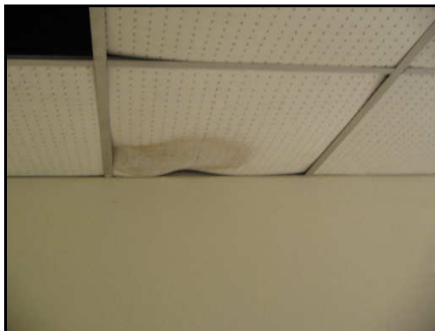
Figura 70. Cielo raso en mal estado del Departamento. de Recursos hidrobiológicos
