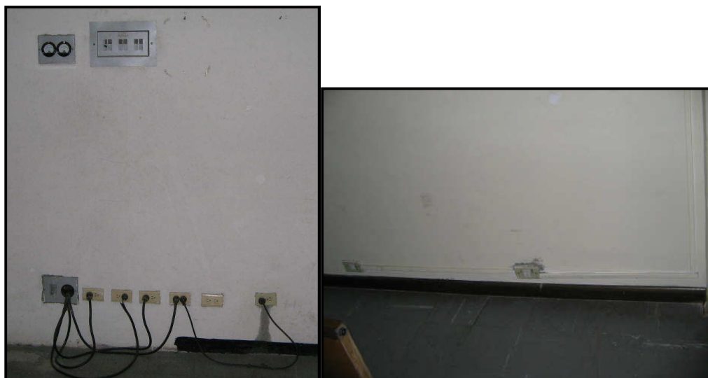
Figura 45. Instalación eléctrica reemplazada del laboratorio 2 del Departamento de Física.
