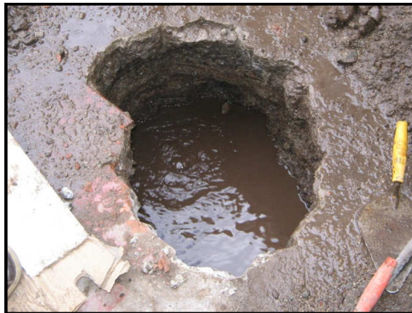
Figura 86. Fuga de agua potable - bloque 3
