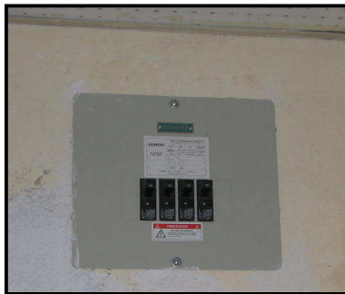
Figura 78. Tablero de breakes del Dep. de Recursos hidrobiológicos
