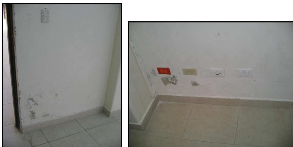
Figura 87. Deterioro de muros – Bloque Derecho
