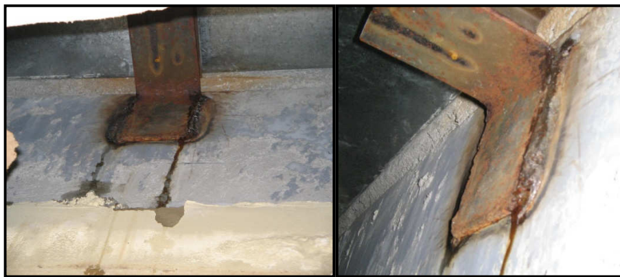
Figura 89. Deterioro del cielo raso – Bloque Derecho
