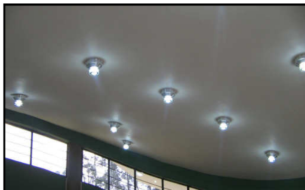
Figura 34. Lámparas instaladas - Kiosco de Internet No. 2
