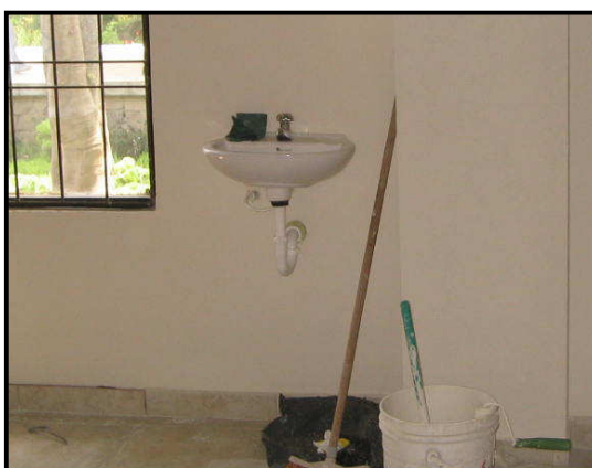
Figura 59. Lavamanos instalado en el laboratorio 2 del Departamento de Física.
