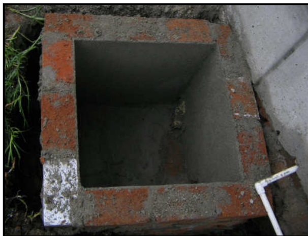
Figura 30. Caja de inspección- Kiosco de Internet No. 2
