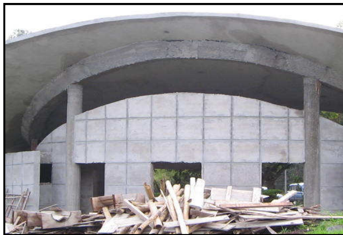
Figura 16. Estrías en el repello - Kiosco de Internet No. 1
