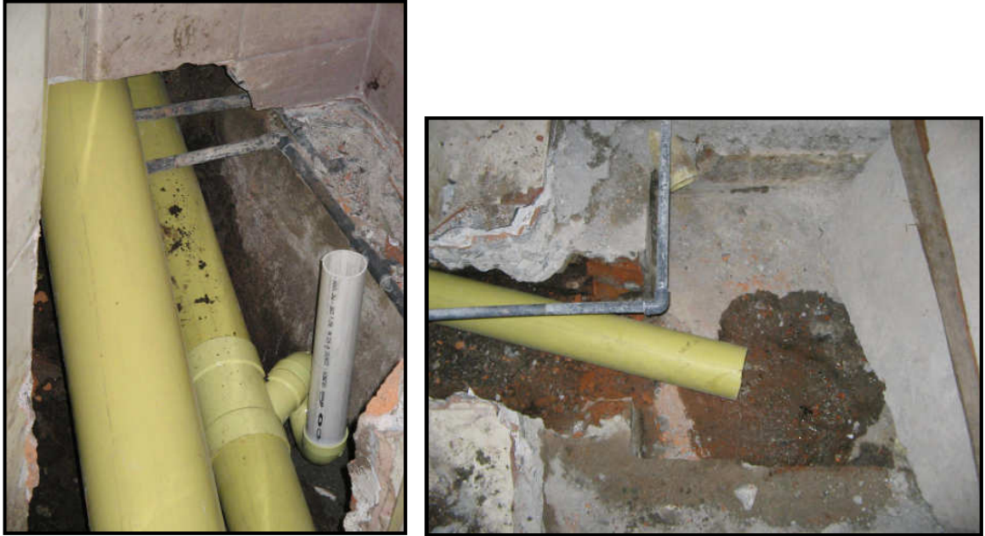
Figura 85. Sustitución de tubería de 4" en PVC y redirección a caja de inspección Baño damas – bloque 3
