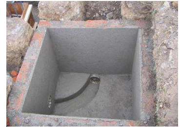
Fig. No 63 Caja de inspección No 3
