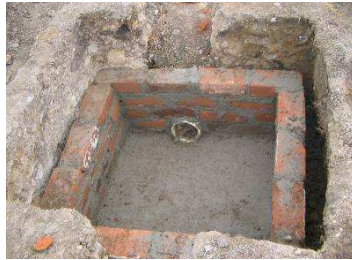
Fig. No 62 Caja de inspección No 2
