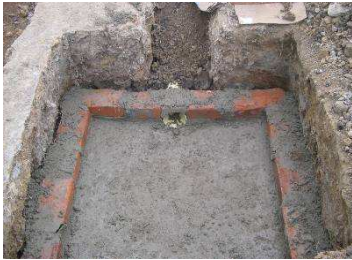
Fig. No 61 Caja de inspección No 1
