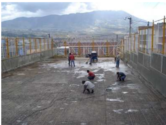
Fig. No 88 Malla electro soldada.
