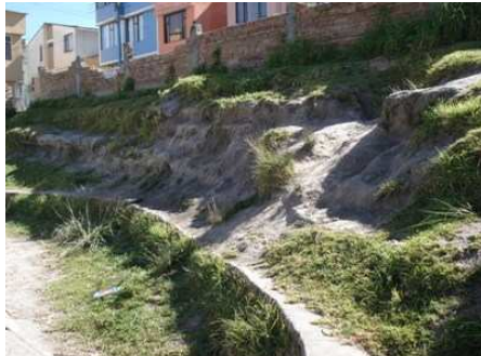
Fig. No 86 Estado inicial graderías
