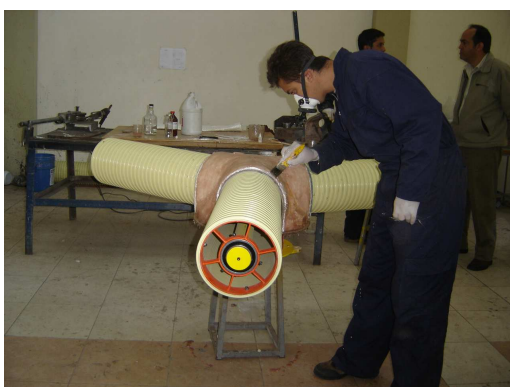
Foto 51. Contra molde en resina de poliéster Y fibra de vidrio cubierta central.
