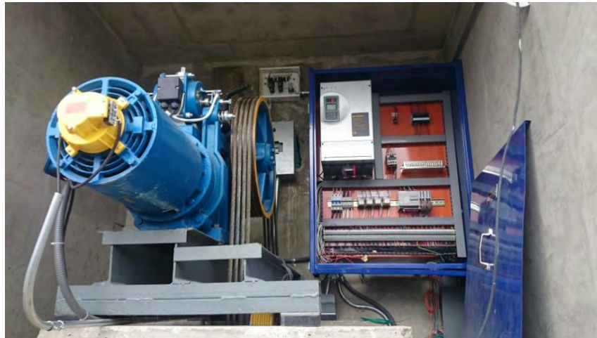
Figura 42. Cuarto de máquinas donde se encuentra el motor y los circuitos que manejan el ascensor
