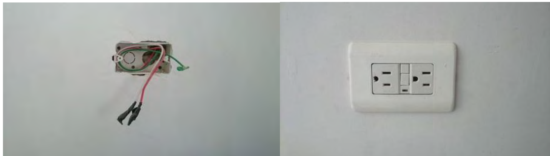
Figura 43. Alambrado y swicheria
