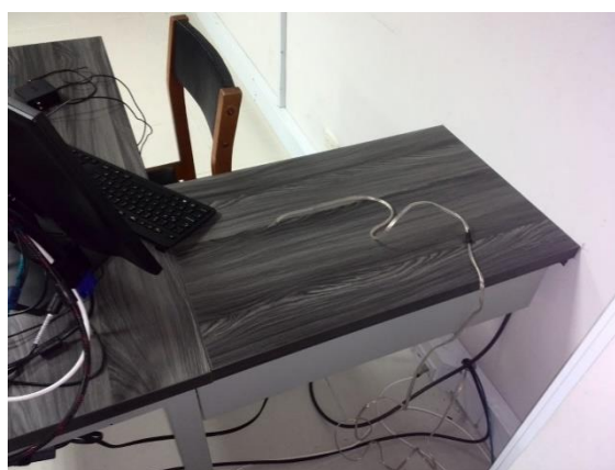
Imagen 4. Aula 405 el cable disponible presenta algunas fallas y por consiguiente no está en su óptimo funcionamiento, el cable de audio está en muy malas condiciones
