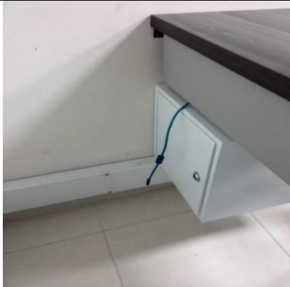
Imagen 3. Aula 404 la longitud del cable para conectar con el computador es insuficiente
