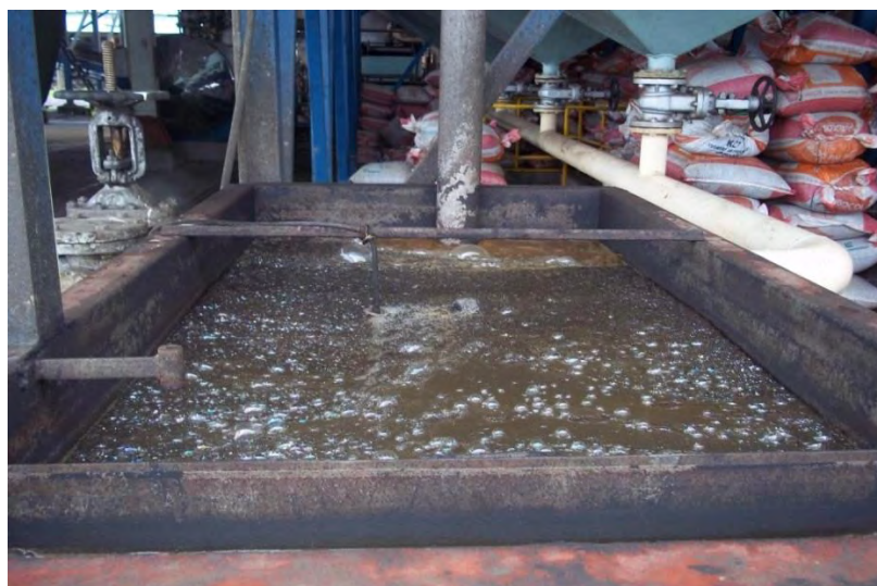
Tanque receptor salida de flujo de efluentes
