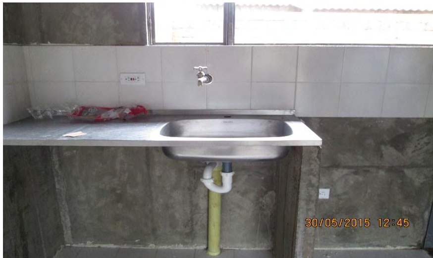
Figura 23. Enchape de pared e instalación de mesón de sobreponer en acero inoxidable en cocina.
