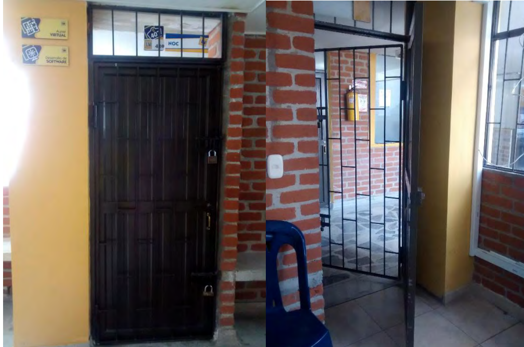
Figura 7. Puerta sala de servidores
