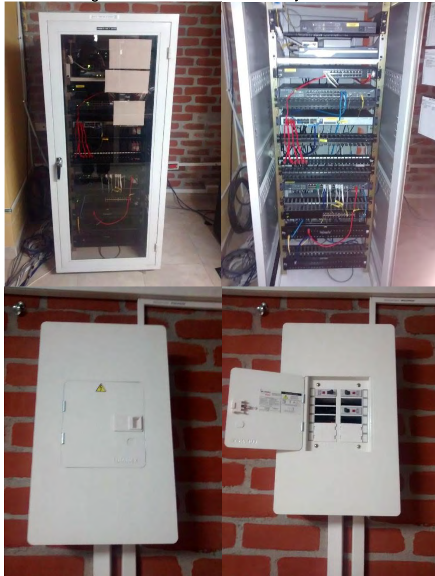
Figura 11. Cableado de datos y eléctrico
