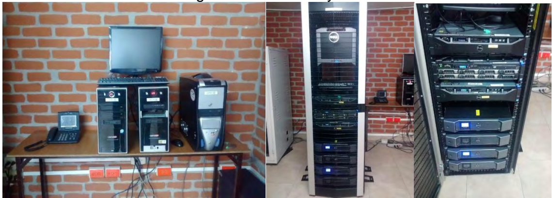
Figura 9. Servidores y UPS
