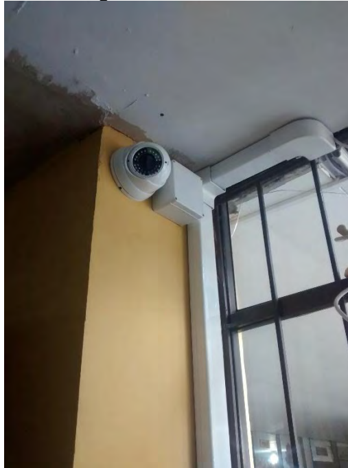
Figura 10. Cámara de seguridad al interior de la sala de servidores
