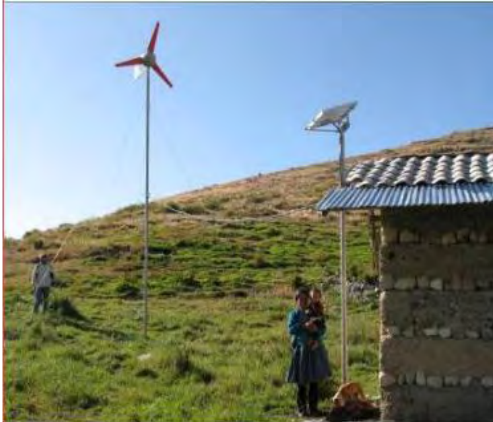
Figura 70. Sistema Instalado en Campo Alegre.
