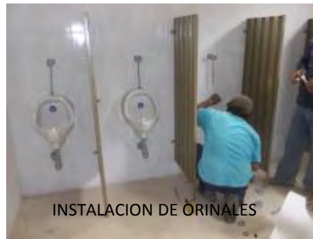
Ilustración 36 Lavamanos, sanitario y orinal
