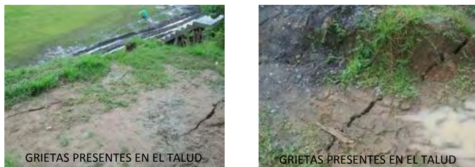
Ilustración 52 Grietas del talud
