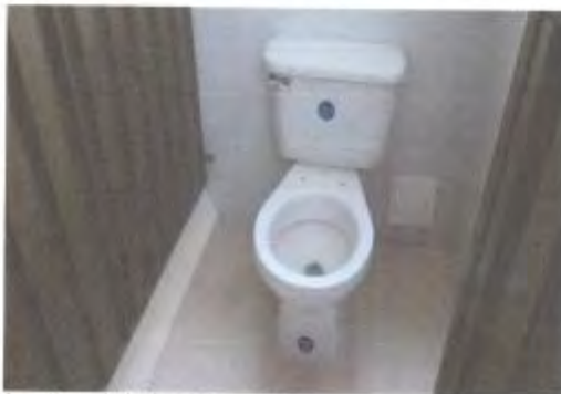
Aparatos sanitarios instalados en baños.
