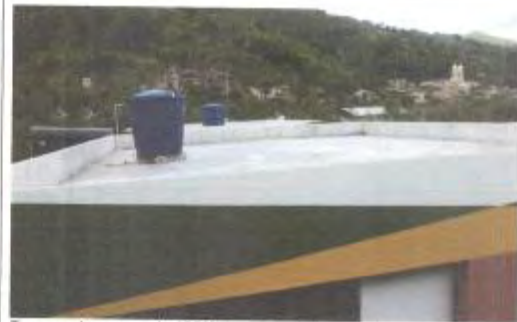
Tanques de reserva de 1000lt, instalados y funcionando para camerinos y batería sanitaria.
