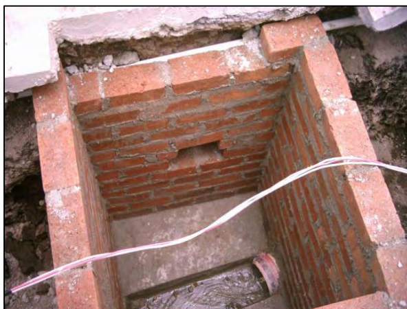
Fotografía 4.1-15. Caja de inspección.
