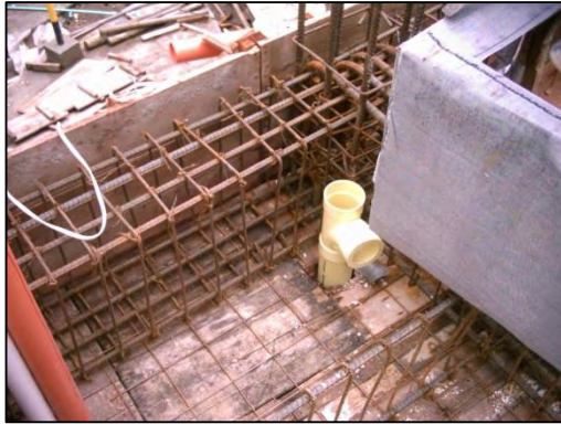
Fotografía 4.1-40. Tuberías sanitarias, aguas lluvias, ventilación y agua potable.
