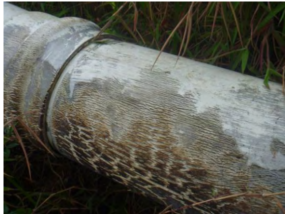
Figura 44. Acartonamiento de tubería en el distrito de ASOGUABARÍN.
