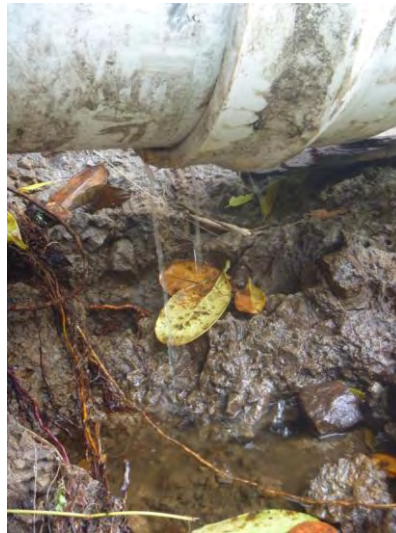
Figura 43. Fuga de agua en el distrito de ASOGUABARÍN.
