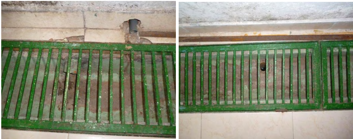
Figura 5.1. Estado de las tuberías de desagüe cuartos fríos.
