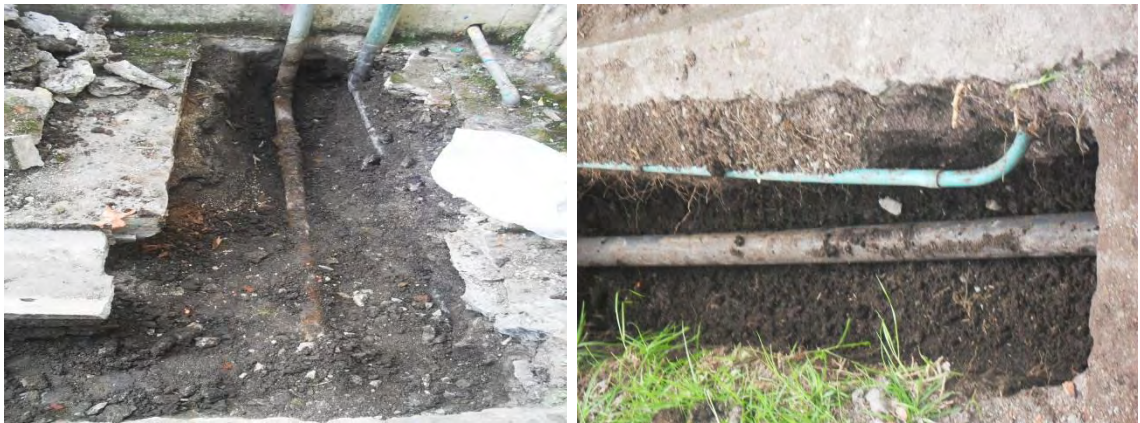
Figura 5.2. Estado de la acometida de agua de la planta piloto.
