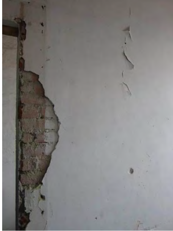
Figura 69. Pérdida de material de revestimiento entrada Centro Cultural Palatino. Fuente: Elaboración Propia.
