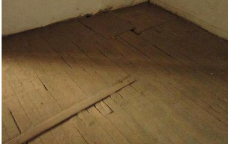
Figura 94. Degradación por la luz en pisos del Centro Cultural Palatino. Fuente: Elaboración Propia.
