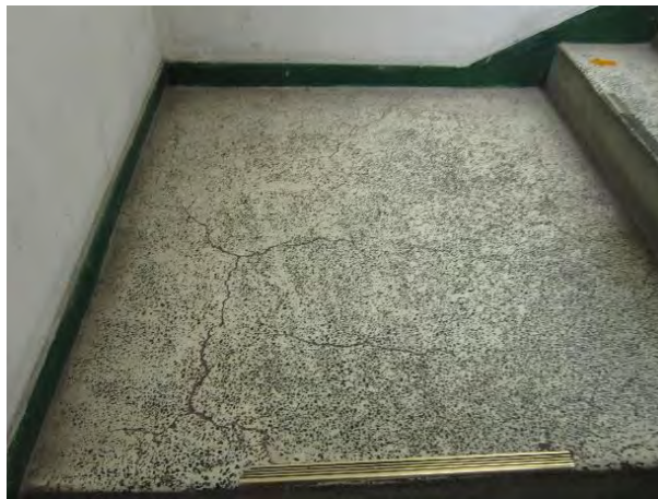
Figura 82. Fisuras en gradas del bloque del Paraninfo. Fuente: Elaboración Propia.
