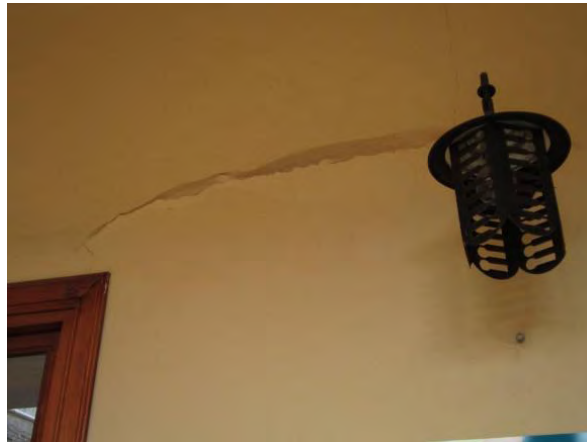
Figura 81. Fisuras cercanas a marcos de puertas del bloque de Música. Fuente: Elaboración Propia.
