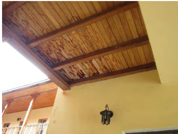
Figura 87. Presencia de moho en entrepisos del bloque de Música. Fuente: Elaboración Propia.
