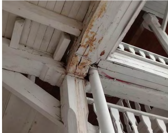
Figura 88. Presencia de moho en uniones estructurales del Centro Cultural Palatino. Fuente: Elaboración Propia.
