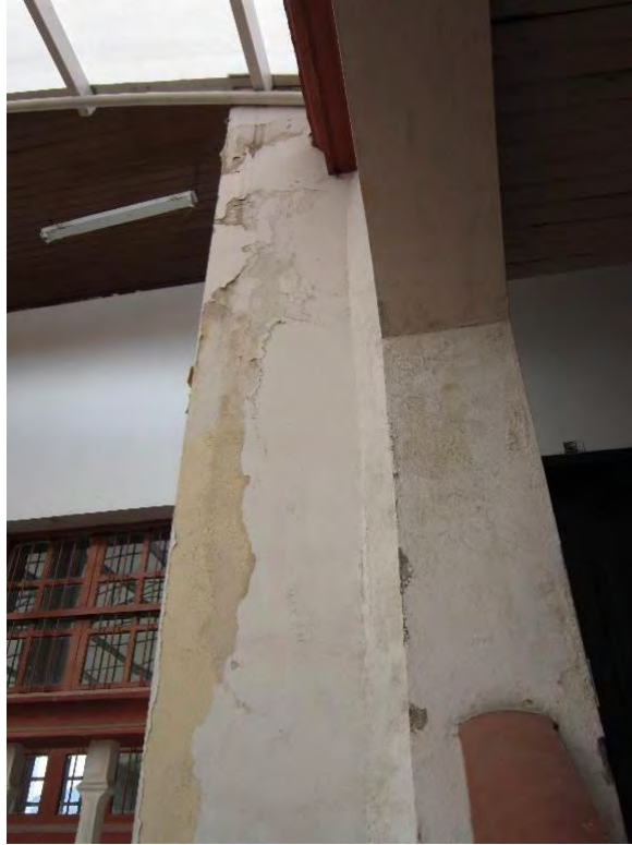
Figura 56. Deterioro por humedad en columnas Casa Cultural Antiguo Liceo. Fuente: Elaboración Propia.
