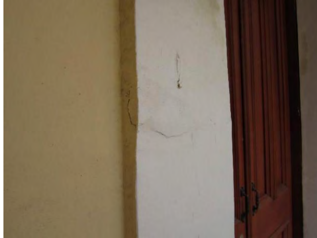
Figura 78. Fisuras presentes en las molduras del bloque de Posgrados de Derecho. Fuente: Elaboración Propia.
