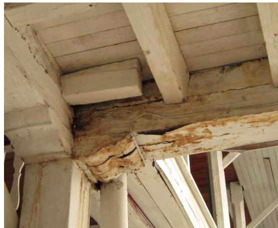
Figura 89. Hongos en pudrición en uniones estructurales del Centro Cultural Palatino. Fuente: Elaboración Propia.
