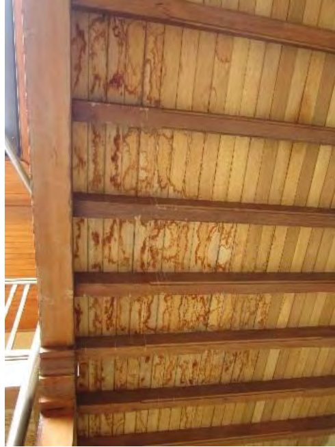
Figura 86. Presencia de moho en entrepisos del bloque de Música. Fuente: Elaboración Propia.
