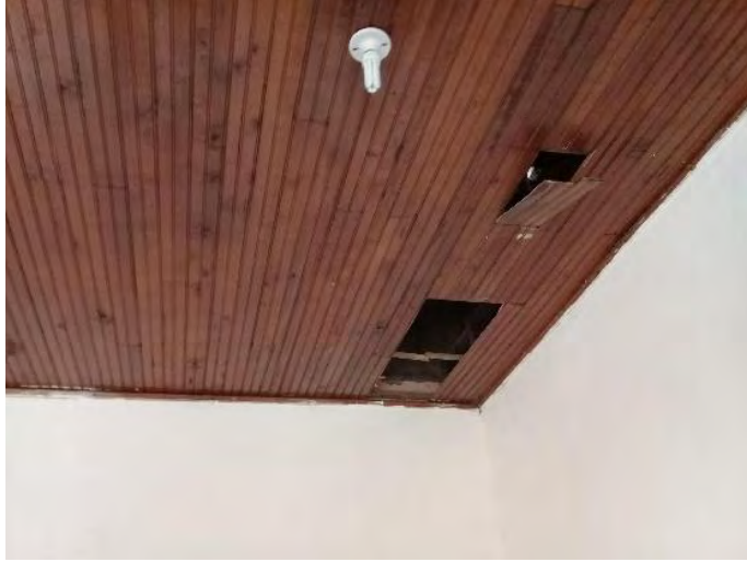
Figura 96. Deterioro en cielo raso de Centro Cultural Palatino. Fuente: Elaboración Propia.
