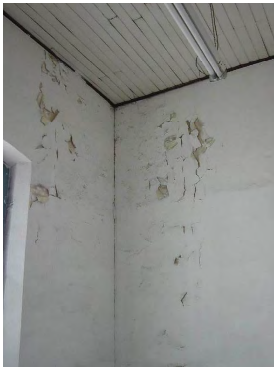
Figura 63. Deterioro por humedad en aulas de música bloque Paraninfo. Fuente: Elaboración Propia.
