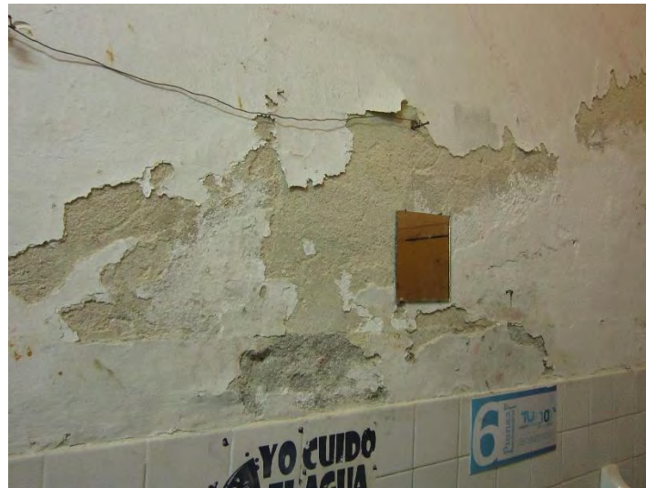
Figura 66. Pérdida de revestimiento en baños de la Casa Cultural Antiguo Liceo, causada por humedad y falta de mantenimiento de la edificación. Fuente: Elaboración Propia.
