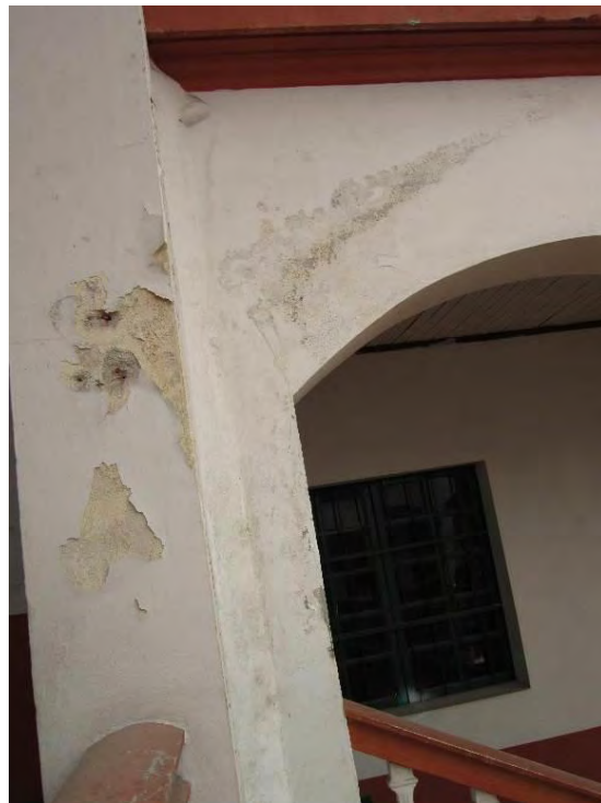
Figura 57. Deterioro por humedad en arcos Casa Cultural Antiguo Liceo. Fuente: Elaboración Propia.
