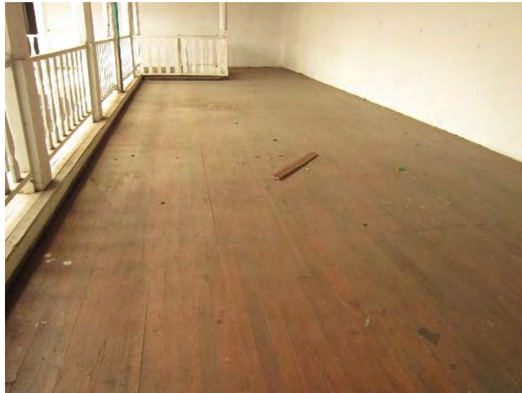
Figura 95. Deterioro en pisos del Centro Cultural Palatino. Fuente: Elaboración Propia.
