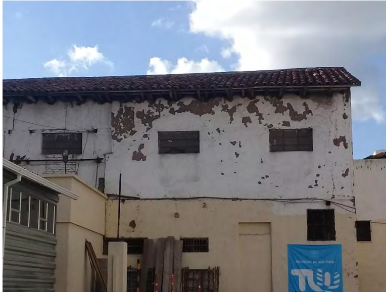
Figura 65. Pérdida de revestimiento en fachada externa Centro Cultural Palatino causado por humedad y falta de mantenimiento de la edificación. Fuente: Elaboración Propia.
