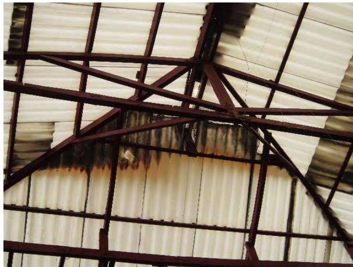
Figura 71. Suciedades presentes en techo del Centro Cultural Palatino. Fuente: Elaboración Propia.
