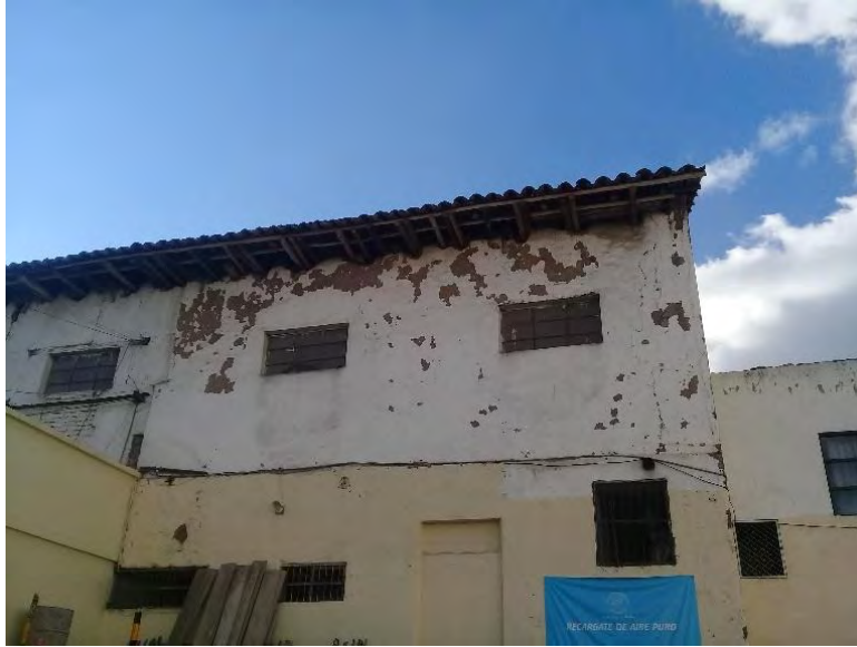
Figura 83. Fisura ubicada en la fachada interior del Centro Cultural Palatino. Fuente: Elaboración Propia.
