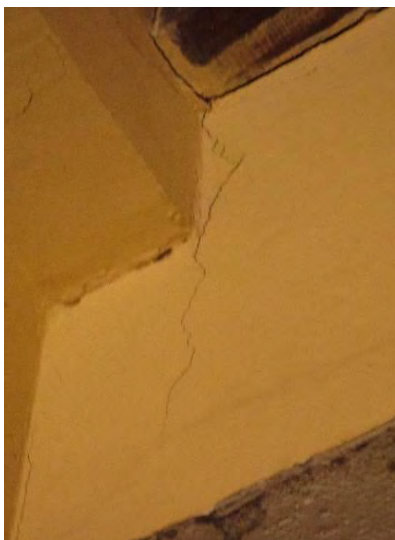
Figura 79. Fisuras presentes en las vigas del bloque de Música. Fuente: Elaboración Propia.
