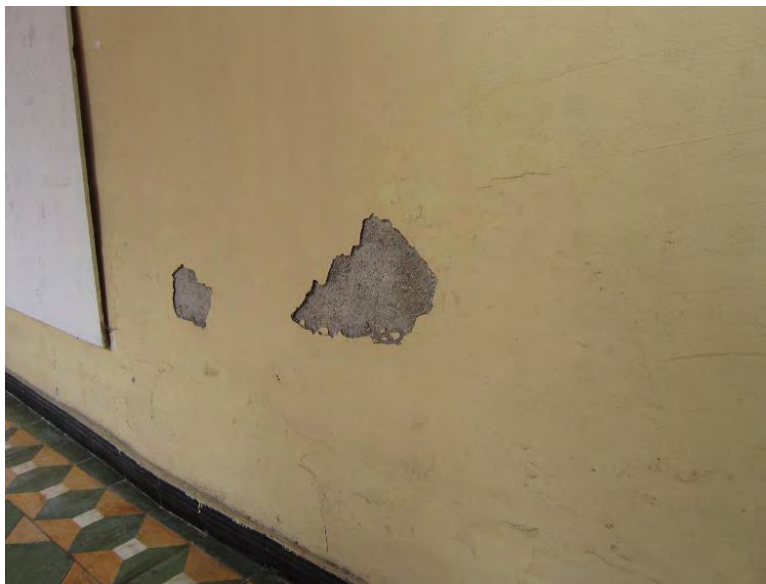
Figura 68. Pérdida de material de revestimiento en muros de la facultad de música. Fuente: Elaboración Propia.
