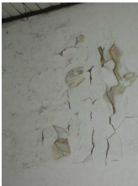
Figura 64. Pérdida de revestimiento por humedad en muros de bloque Paraninfo. Fuente: Elaboración Propia.
