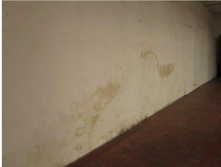
Figura 61. Humedades presentes en el Centro Cultural Palatino. Fuente: Elaboración Propia.
