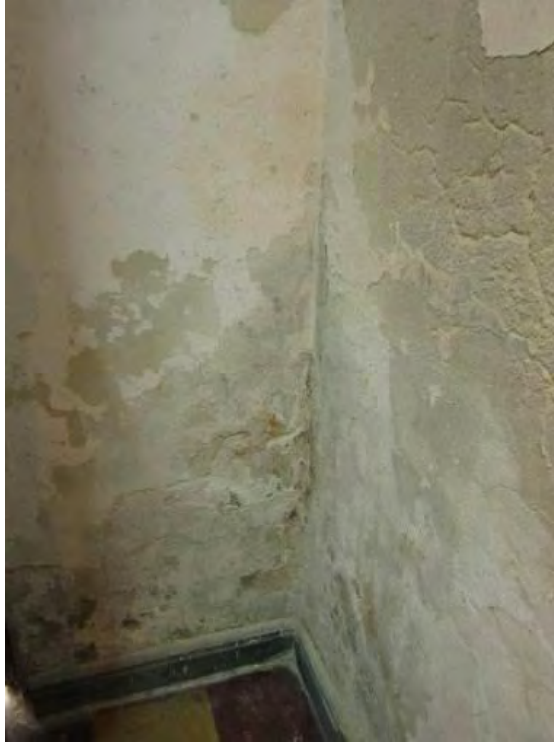
Figura 59. Deterioro por humedad en muros inferiores en Casa Cultural Antiguo Liceo. Fuente: Elaboración Propia.
