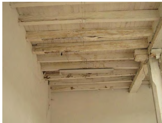
Figura 85. Presencia de moho en uniones estructurales de Centro Cultural Palatino. Fuente: Elaboración Propia.
