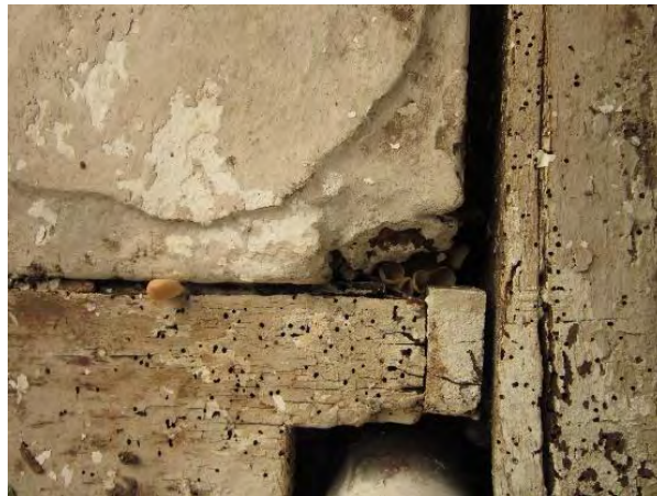
Figura 91. Deterioro por insectos en uniones estructurales del Centro Cultural Palatino. Fuente: Elaboración Propia.
