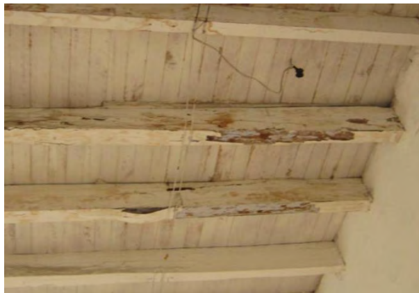
Figura 84. Presencia de moho en entrepisos de Centro Cultural Palatino. Fuente: Elaboración Propia.
