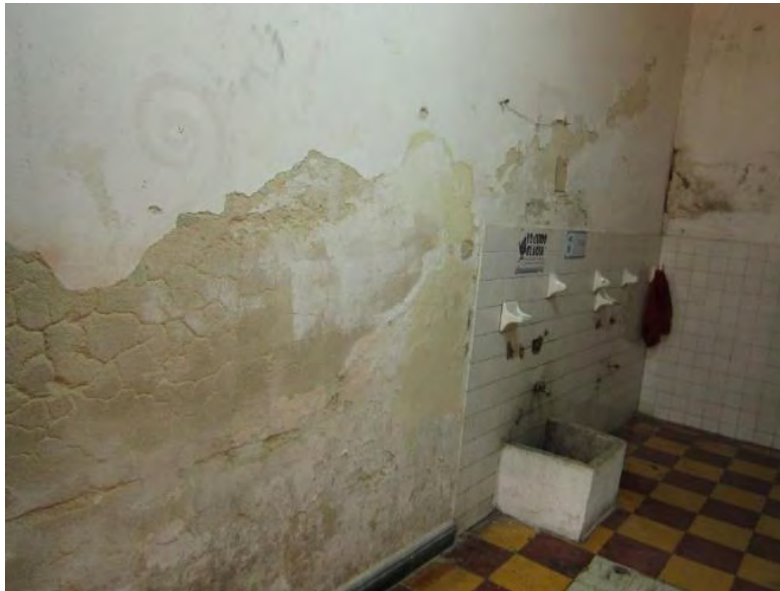
Figura 58. Deterioro por humedad. Fuente: Elaboración Propia.
