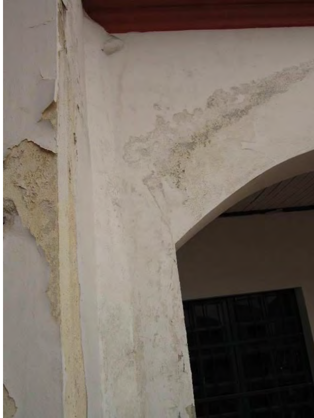
Figura 55. Deterioro por humedad. Fuente: Elaboración Propia.
