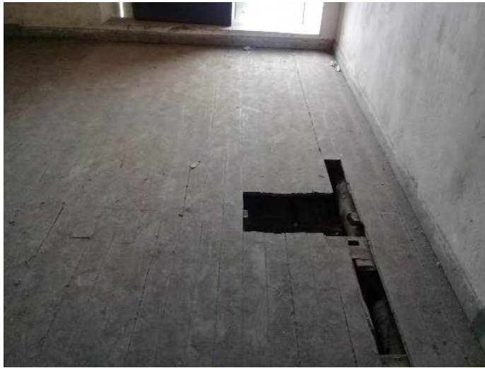
Figura 97. Deterioro en pisos en el Centro Cultural Palatino. Fuente: Elaboración Propia.
