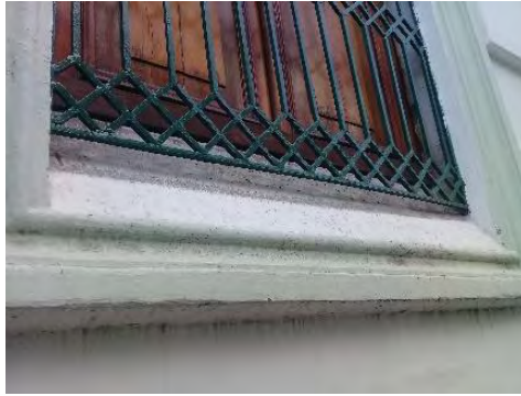
Figura 74. Suciedad en las fachadas Carrera 22. Fuente: Elaboración Propia
