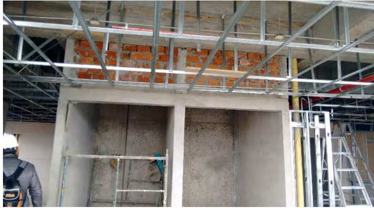
Imagen 28. Ascensor hasta el 3er piso hospital civil de Ipiales.
