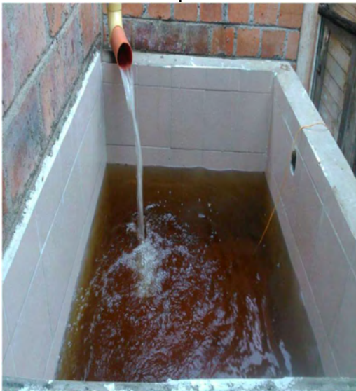
Ilustración 26. Tanque de almacenamiento.
