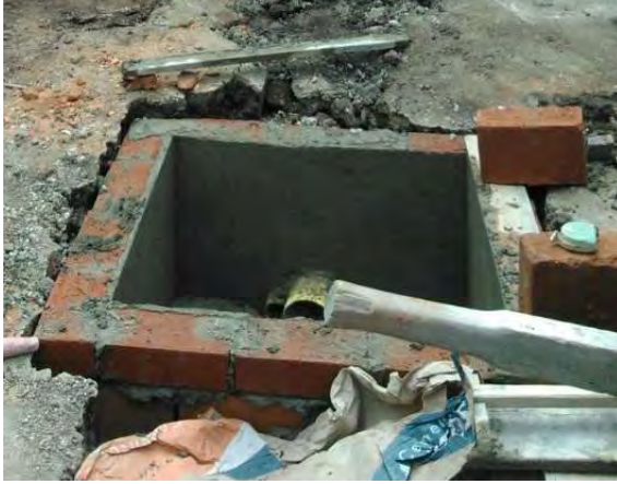
Ilustración 17. Caja de inspección.
