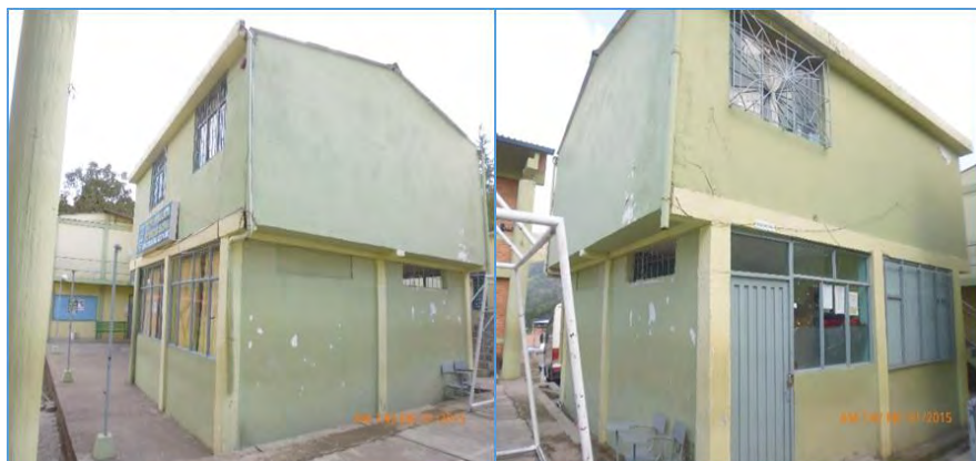
Figura 42. Agrietamientos en los muros de aulas y fisuras en columnas y vigas de la estructura de la Institución Educativa Cartago
