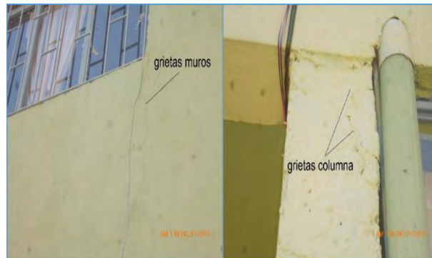
Figura 43. Agrietamientos en los muros de aulas y fisuras en columnas y vigas de la estructura de la Institución Educativa Cartago
