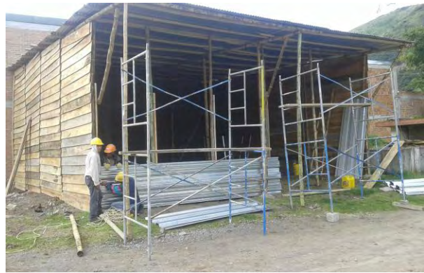
Figura 5. Cubierta en lámina de zinc campamentos (incluye estructura de cubierta en guadua).
