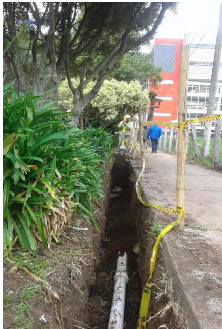
Figura 10. Acometida de red de agua potable en 4"
