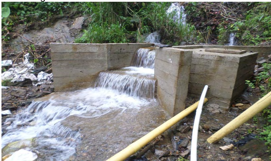
Figura 16. Prueba funcionamiento de la bocatoma.
