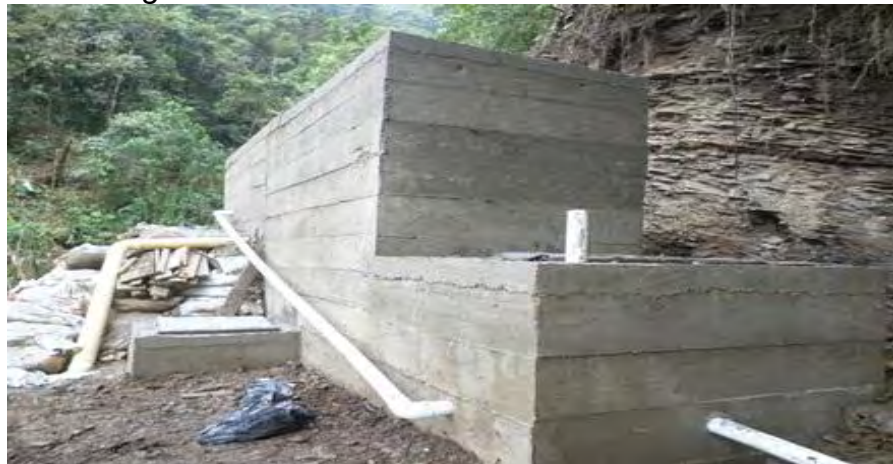
Figura 17. Instalaciones del desarenador
