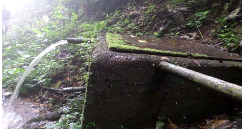
Figura 27. Captación existente, vereda San Miguel
