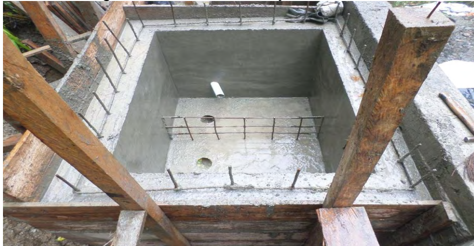
Figura 12. Instalaciones caja de derivación
