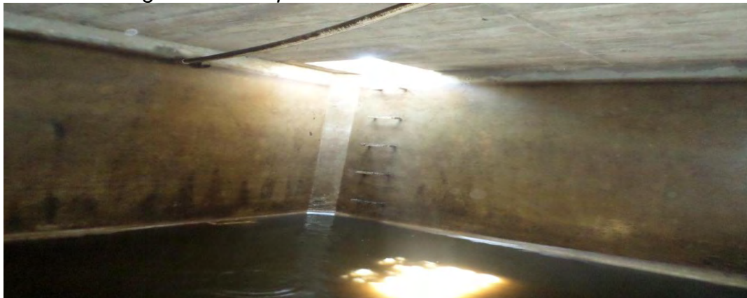
Figura 23. Tanque de almacenamiento Santa Rosa
