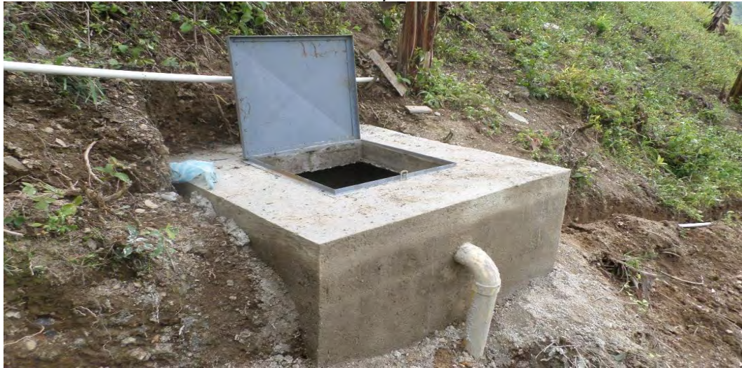
Figura 18. Cámara de quiebre Loma Pamba.
