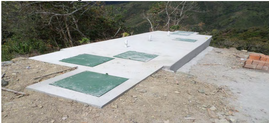
Figura 21. Desarenador Santa Rosa
