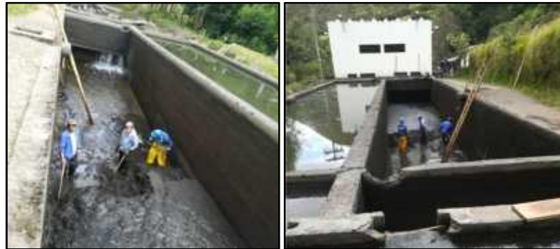
Figura 19. Lavado de desarenadores, drenaje y evacuación de sedimentos
