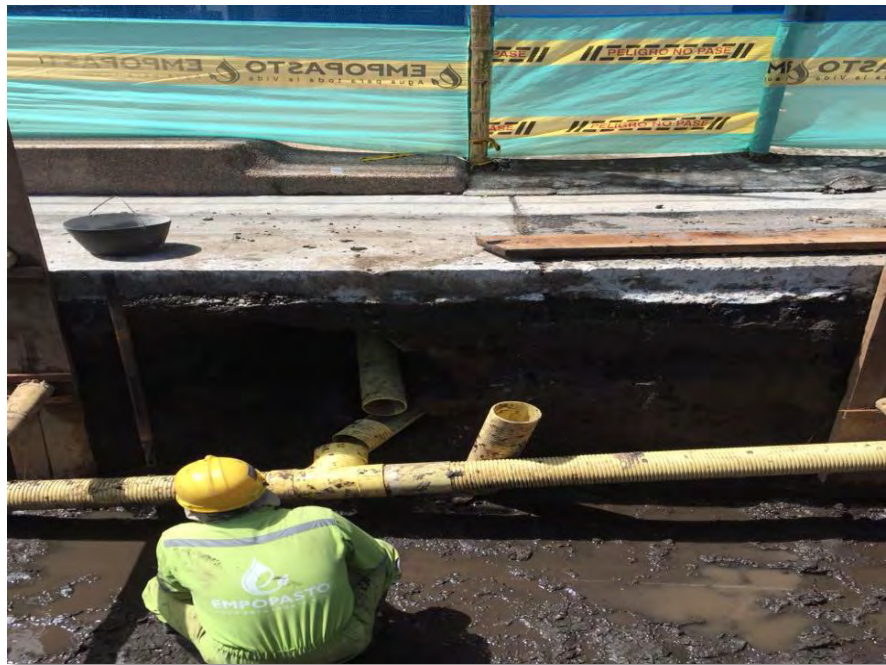
Figura 74. Visualización de tubería PVC NOVAFORT de 6” para permitir el manejo de aguas negras.
