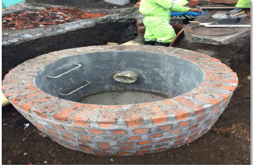
Figura 75. Visualización de pozos de inspección
