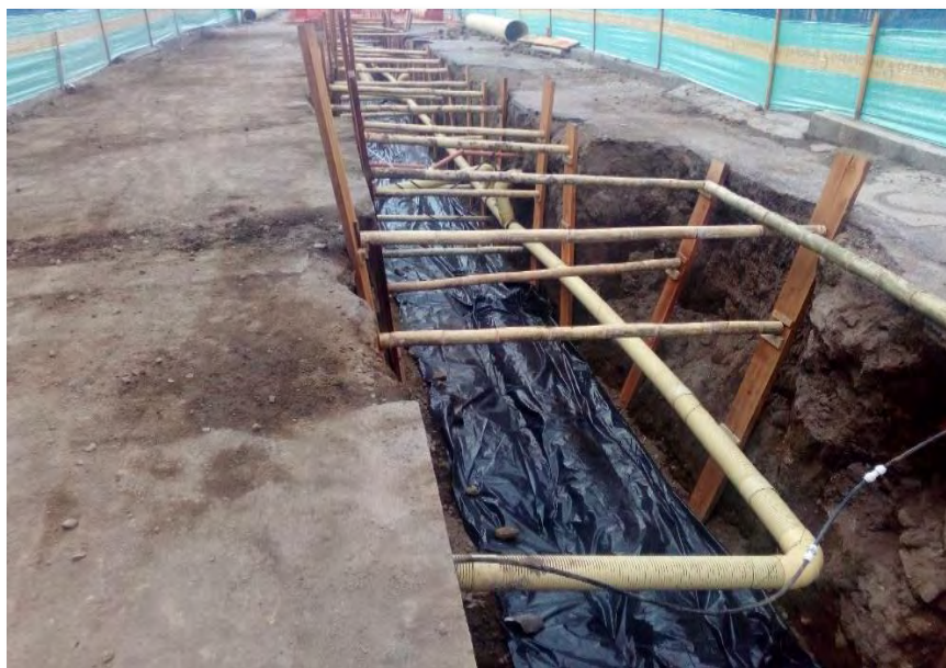
Figura 31. Visualización de tubería PVC NOVAFORT de 6'' para permitir el manejo de aguas negras.
