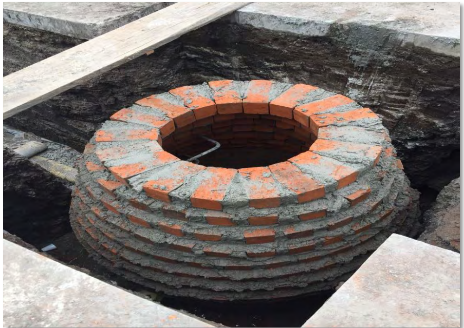
Figura 76 Visualización de pozos de inspección
