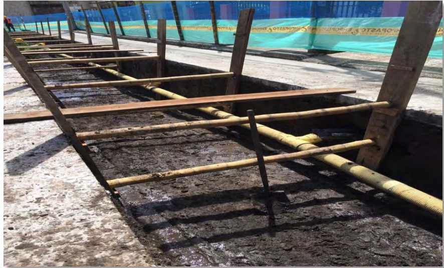
Figura 73. Visualización de tubería PVC NOVAFORT de 6” para permitir el manejo de aguas negras.
