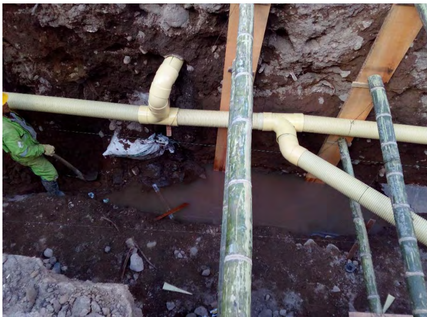
Figura 30. Visualización de tubería PVC NOVAFORT de 6'' para permitir el manejo de aguas negras.
