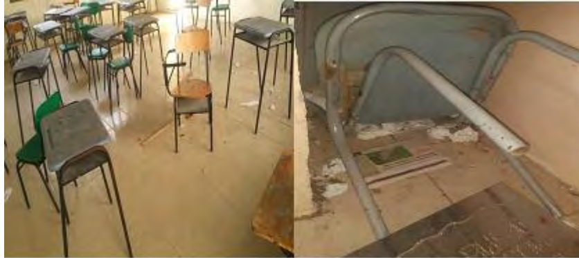
Aula con problemas de aseo. Fuente: Esta investigación
