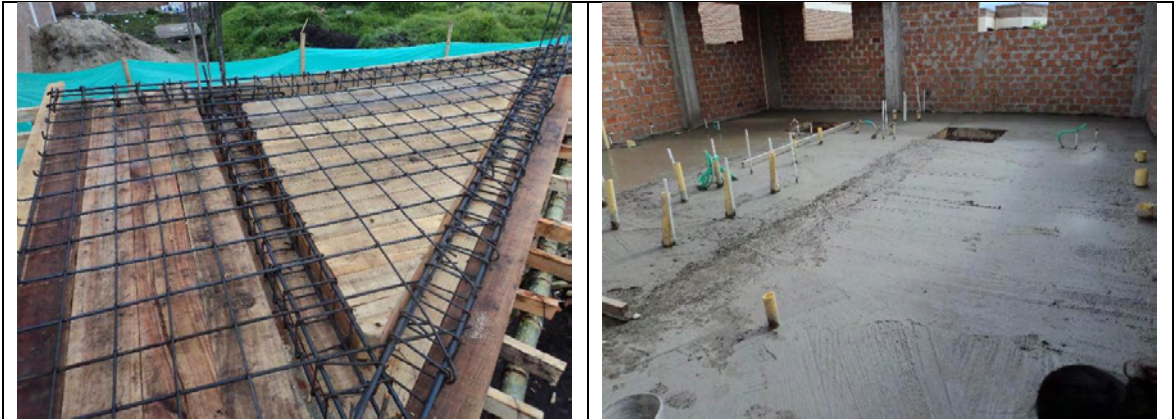
Imagen 24. Acero de refuerzo para losa aérea y concreto para losa de piso obra casa de cabildo Ipiales
