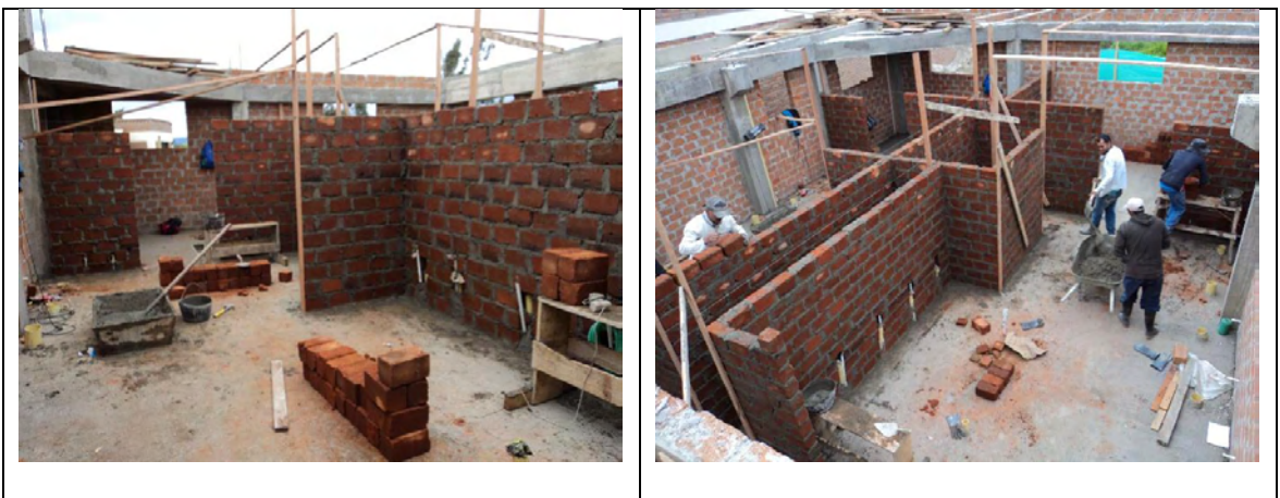
Imagen 25. Muros en soga ladrillo común en obra casa de cabildo de Ipiales
