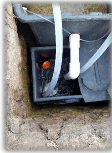
Figura 13. Sumidero, bomba y entrada de reboses.
