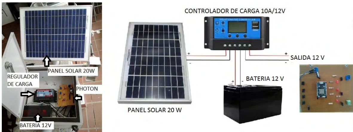
Figura 21. Componente fotovoltaico completo.
