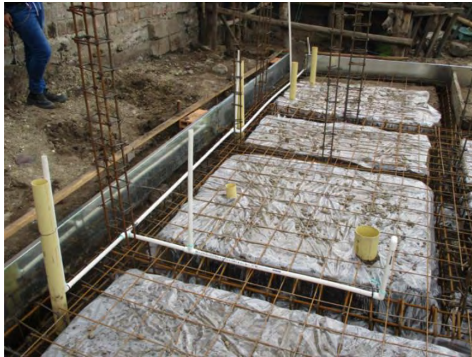
Imagen 32 - Red hidráulica vivienda de Emelda Noguera (San Juan)
