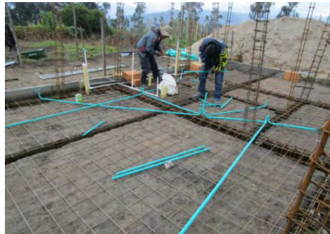
Imagen 35 - Red eléctrica en pisos. Vivienda de Johon Morán (San Juan)
