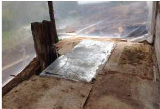
Figura 1 Vista interna área de compostaje
