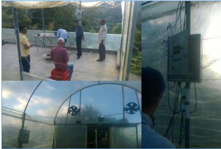
Figura 83. Instalación sistema de control en secador solar de café.
