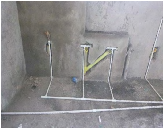
Foto 57: Instalaciones hidráulicas en baños públicos.
