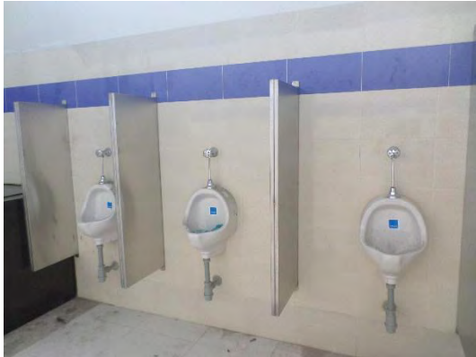
Foto 59: Enchape y orinales baño público para hombres.
