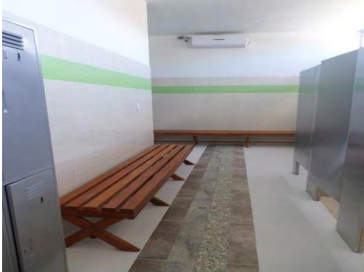
Foto 79: Aire acondicionado camerinos.
