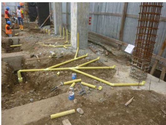
Foto 55: Instalación sanitaria baños públicos.
