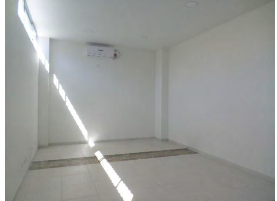
Foto 80: Aire acondicionado zona administrativa.
