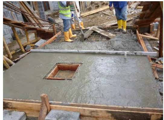
Foto 78: Fundición tapa tanque agua potable.
