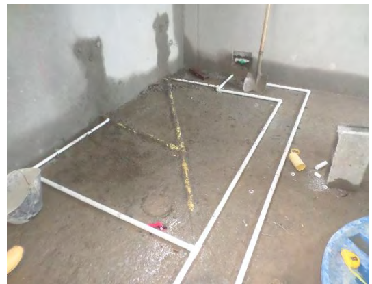
Foto 58: Instalaciones hidráulicas en camerinos.
