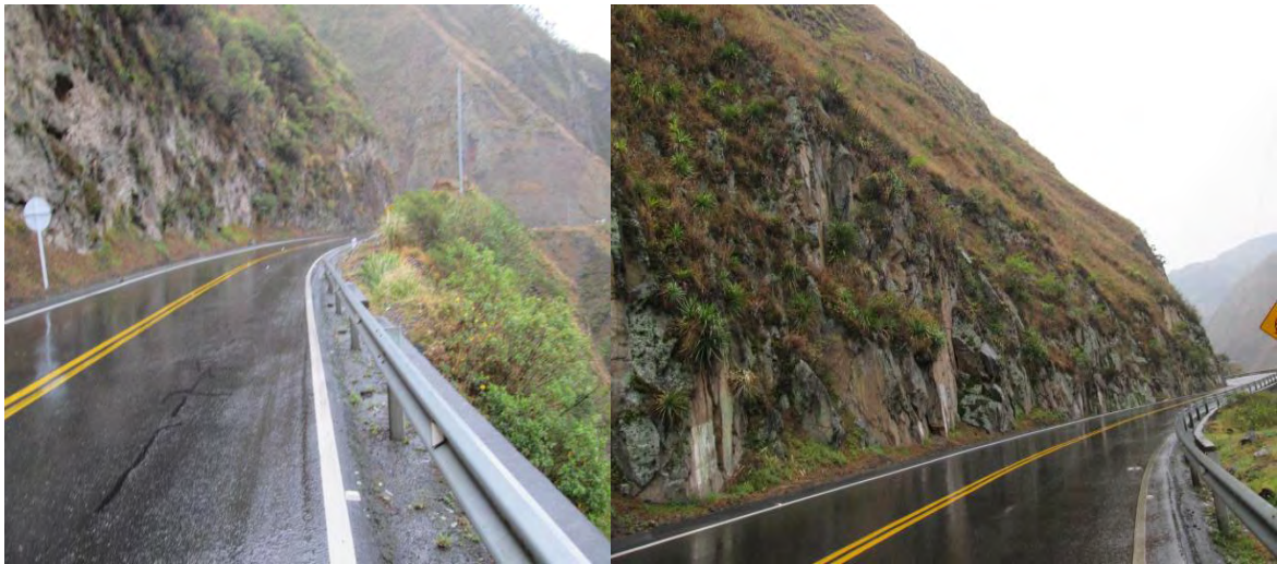
Figura 6. Ancho de berma reducido PR 27+000 Y PR 30+000 respectivamente
