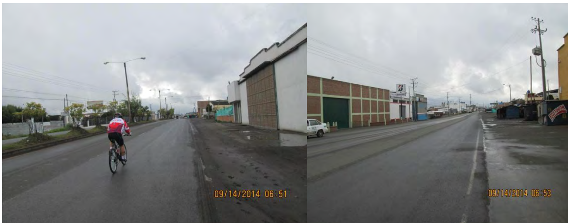
Figura 3. Estado de las demarcaciones longitudinales PR 5+000 al PR 6+000
