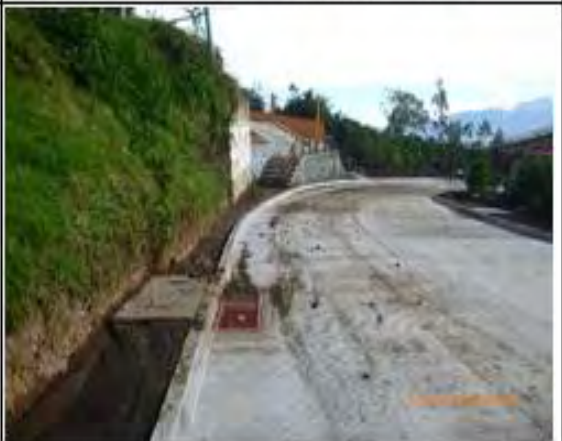
FOTOGRAFIA 16. Sumidera con rejilla y tapa en concreto K0+154
