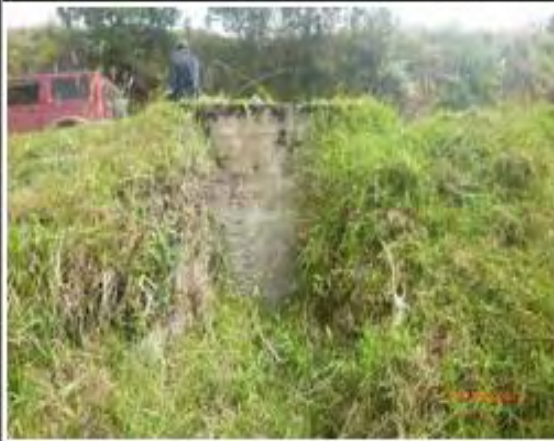
FOTOGRAFIA 13. Alcantarilla colmatada K5+344
