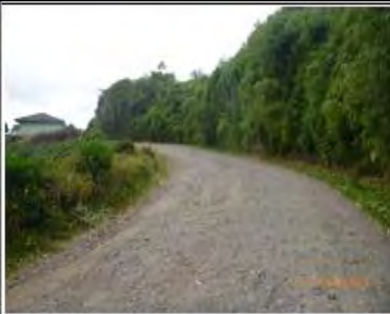
FOTOGRAFIA 11. Vegetación excesiva al margen derecha de la vía K4+000
