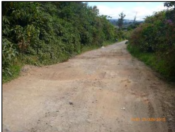
Fotografía 3. Fallos en subrasante, baches en la vía K4+785.
