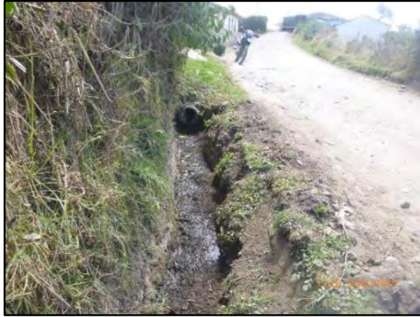
Fotografía 7. Presencia de aguas servidas con descole a la cuneta K6+900.
