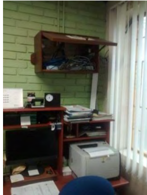
Figura 11. gb5 (gabinete 5 subsistemas)
