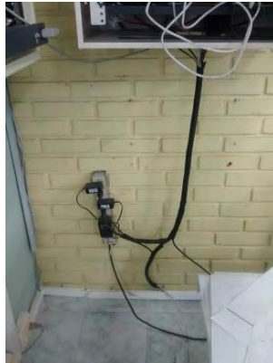
Figura 7. gb3 (gabinete 3 subsistemas)
