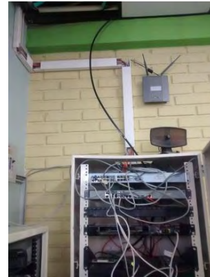
Figura 8. gb3 (gabinete 3 subsistemas)
