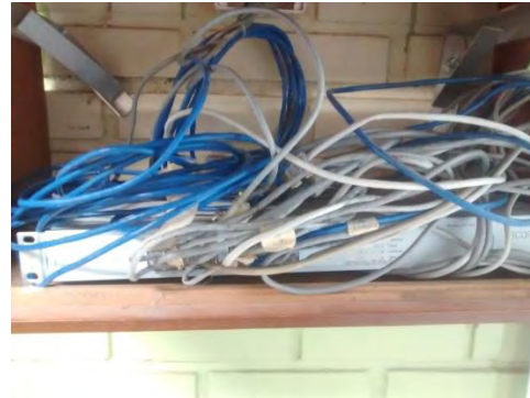
Figura 12. gb5 (gabinete 5 subsistemas)
